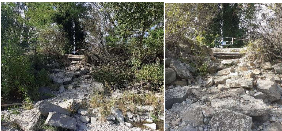
Photo 3-72 : glissement PK13.9 environ ; septembre 2023
