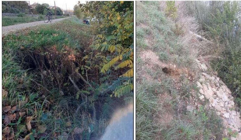
Photo 3-86 : glissements ponctuels PK13.52 RD
