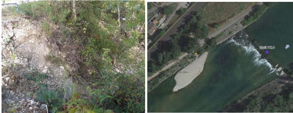
Photo 3-73 : glissement PK13.9 environ – présence du perré maçonné + localisation ; septembre 2023
