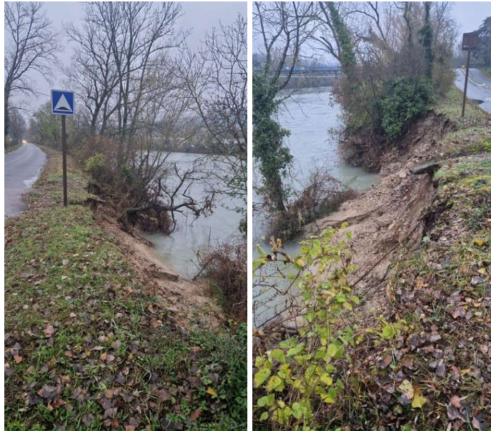
Photo 3-25 : PK15.15 ; source : Segapal, 14 décembre 2023
