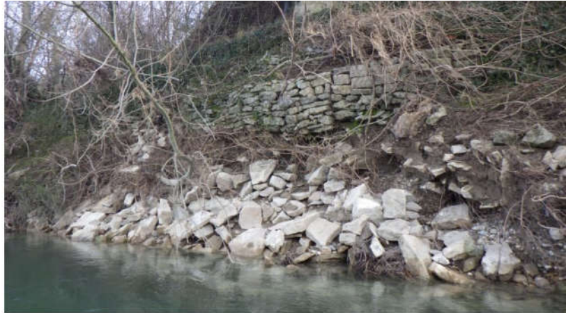
Photo n°13 - Culée rive gauche - Effondrement et érosion de berge laissant apparaître des gabions éventrés
