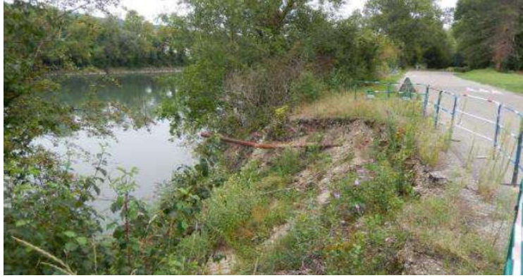
Photo 8-1 : désordre au PK15.45 environ
