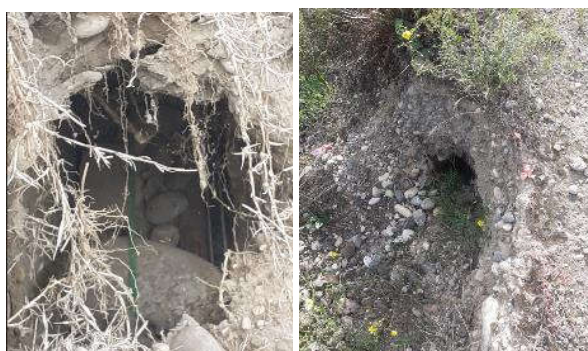
Photo 8-4 : érosion de conduit au droit de la fibre ; source : hydratec 09/23
