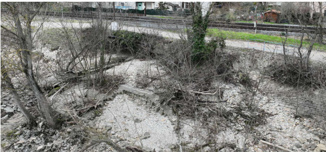
Photo 9-1 : berge en amont immédiat du franchissement du Molliet (gauche) et fosse d'érosion (droite)
