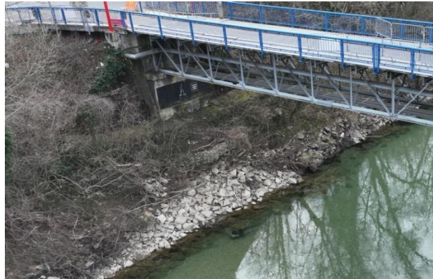
Photo IV-2 : berge RG au droit du pont de l'île
