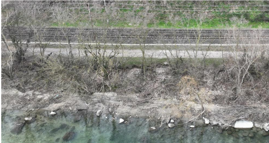
Photo III-3 : front d'érosion en haut de berge PK13.3 ; source : setec
