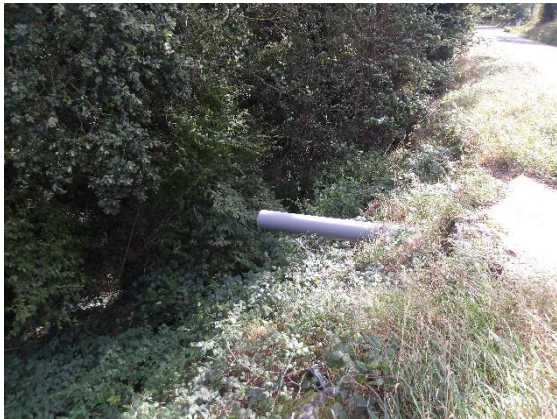
Rejet pluvial de la route sur le ruisseau de Marmont
