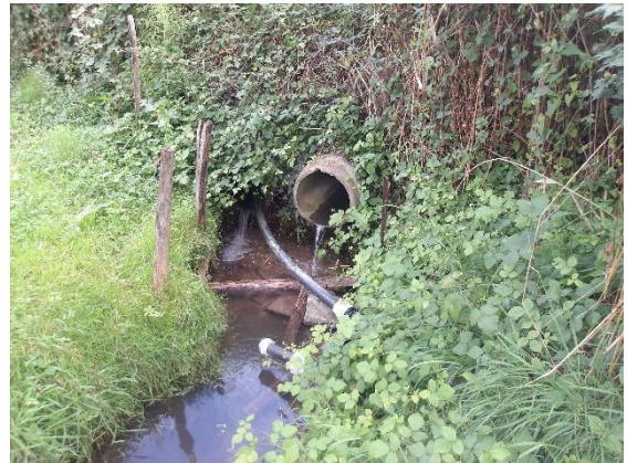
Rejet pluvial sur ruisseau du By
