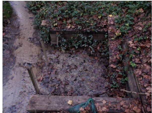
Source provenant de la rive droite
