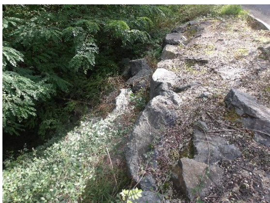
Enrochement sur le ruisseau de Marmont
