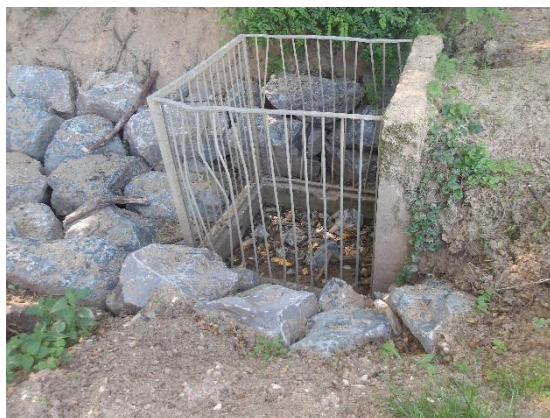
Ouvrage de régulation hydraulique sur le ruisseau du Buisson
