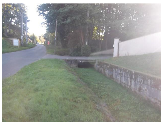
Présence de maintien de berge en génie civil altérant le compartiment
