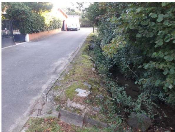
Lit mineur en mauvais état en lien avec des travaux hydrauliques d'aménagement urbain
