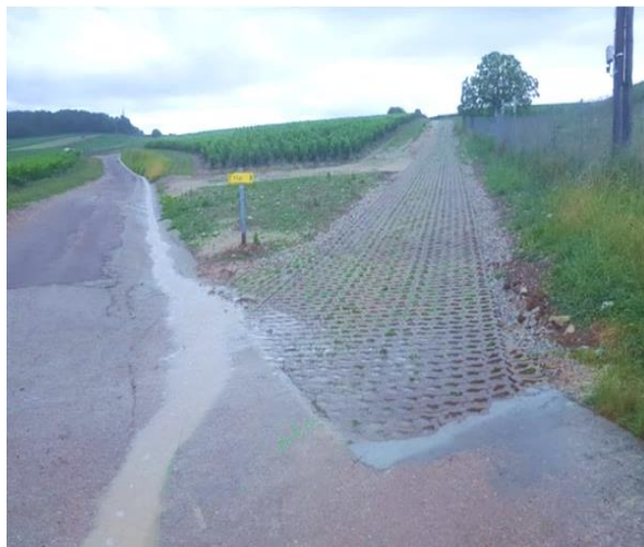
Figure 41 : Différence de comportement entre chemins en béton et en dalle gazon, ASA de Chablis, photo prise en juin 2020 (CEREG Champagne, 2024)
