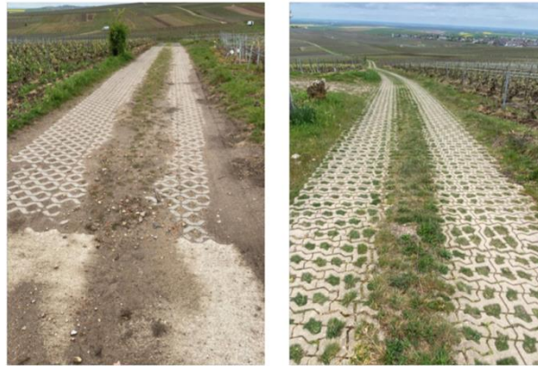
Figure 48 : Deux dalles gazon du site d'Ambonnay. (Photo prise en avril) A gauche : installation précoce, mauvaise gestion des sédiments en amont. A droite : dalle fonctionnelle.
