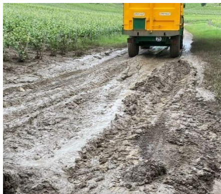
Figure 37 : Ornières et coulées de boue à la suite d'un orage à Venteuil (Le Parisien, 2022)
