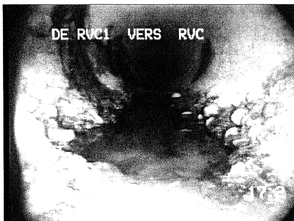
Photo: 4_3b Corrosion généralisée sur l'ensemble du tronçon avec infiltration
