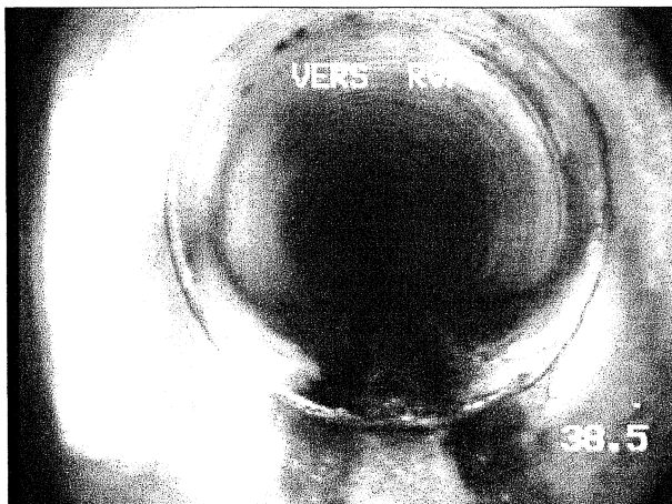
Photo: 11_3b Joint défectueux (élastomère) de 05 à 08 h.
