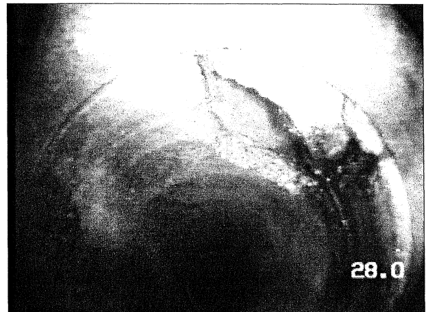
Photo: 2_6a Raccordement mal renformi à 01 h.
