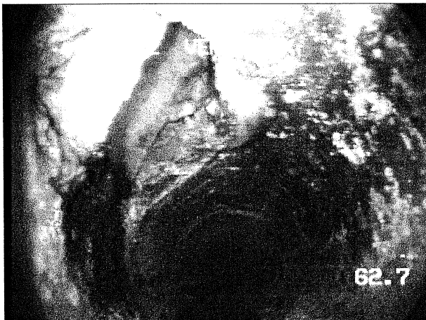
Photo: 3_19a Raccordement mal renformi à 10 h.
