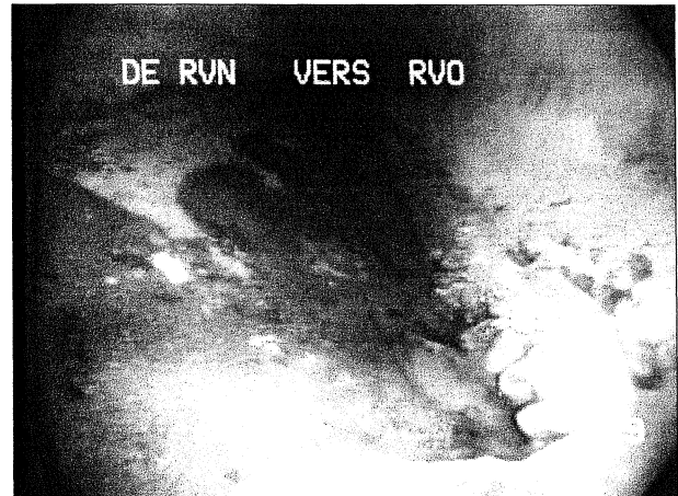
Photo: 7_3a Corrosion totale de 04 à 08 h.
