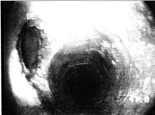
Photo: 3_17a Raccordement mal renformi à 10 h.
