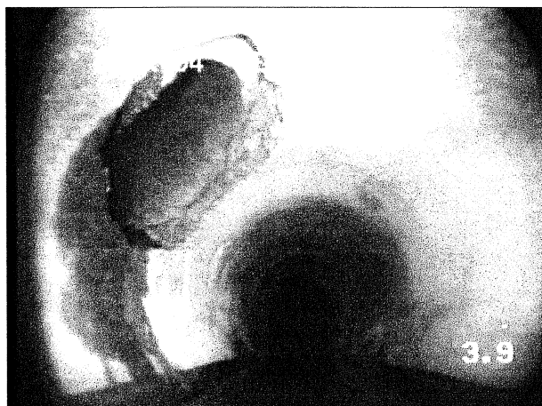
Photo: 1_3a Raccordement mal renformi à 10 h. non étanche
