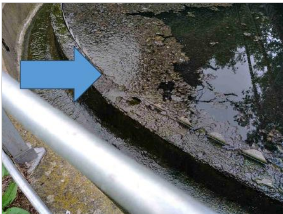
Lame crénelée du clarificateur partiellement décrochée
