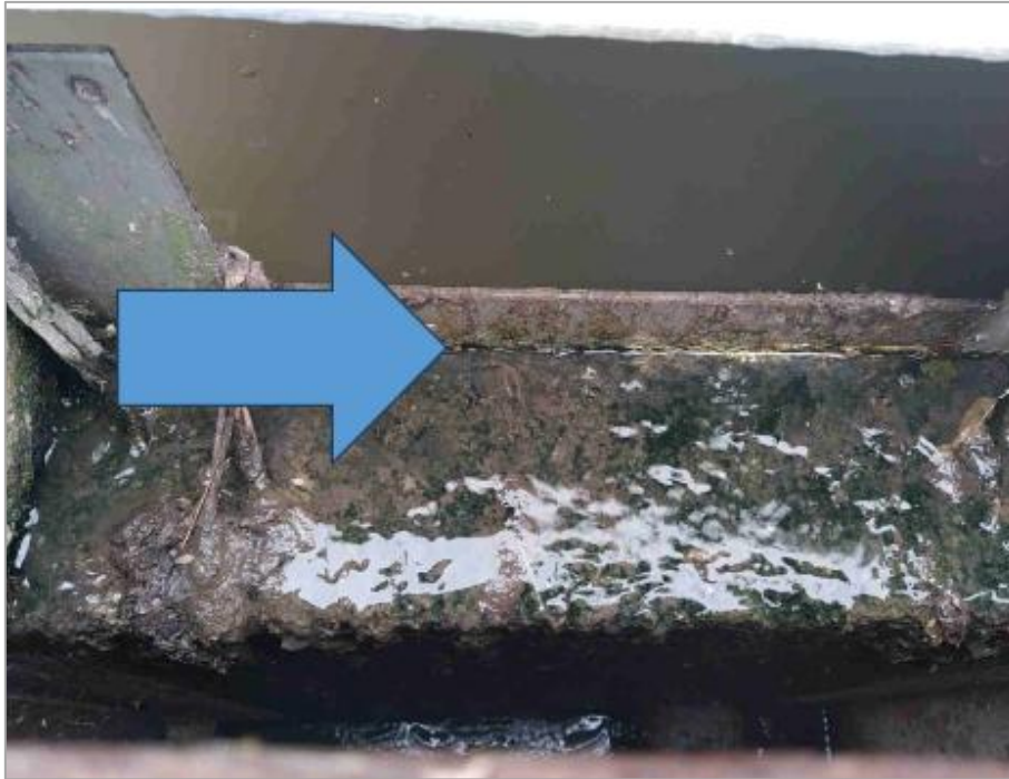
Déversoir d'orage fuyard
