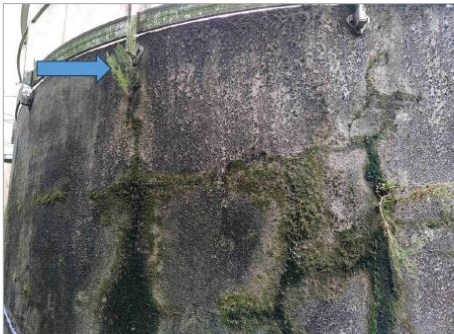
Fissuration de la paroi du lit bactérien
