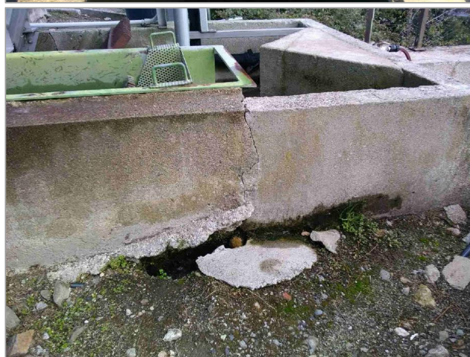
Poste de dégrillage
