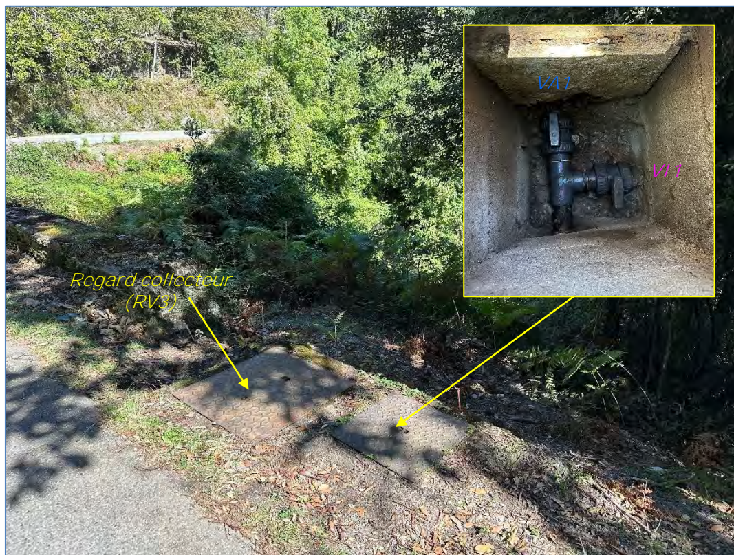
Photographies 1 : Localisation de la vidange VI1 et de la vanne VA1 du réseau d'adduction de la source de Figa au regard collecteur (RV3)
