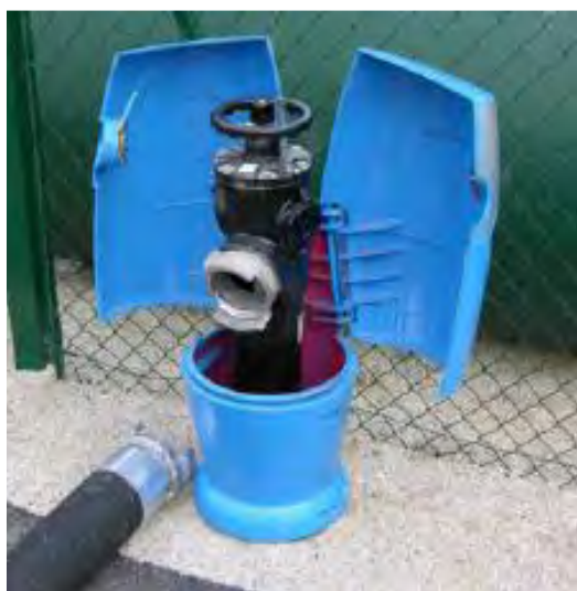
Exemple de poteau d'aspiration
