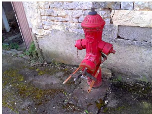
PI 2 : Absence de numérotation, peinture à refaire, espace libre non réglementaire, poteau à 40 cm d'un mur, difficultés pour ouverture, pas de vis sur bouchon de 100 détérioré, le bouchon ne tient plus sur poteau
