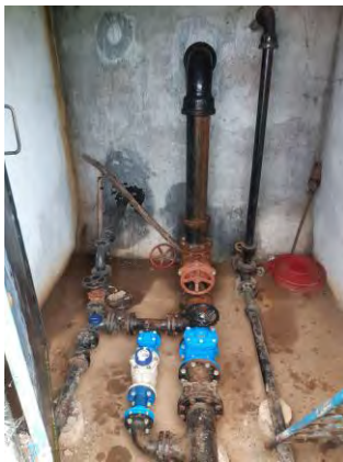
Chambre de vannes
