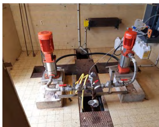
Groupe de pompage
