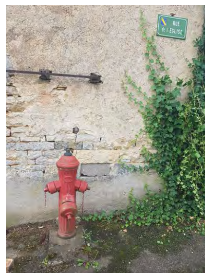
Poteau incendie rue de l'Eglise
