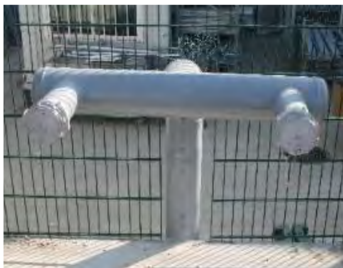
Exemple de colonne d'aspiration
