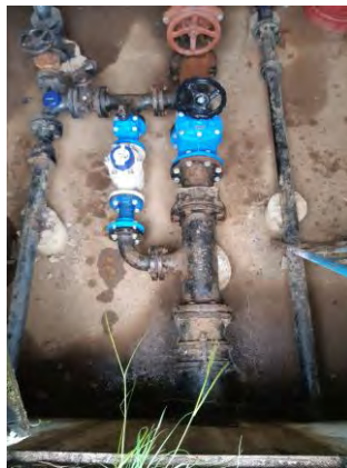
Chambre de vannes
