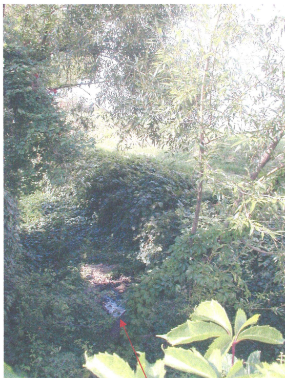
Traces d'eaux usées ruisseau de l'Aleau
