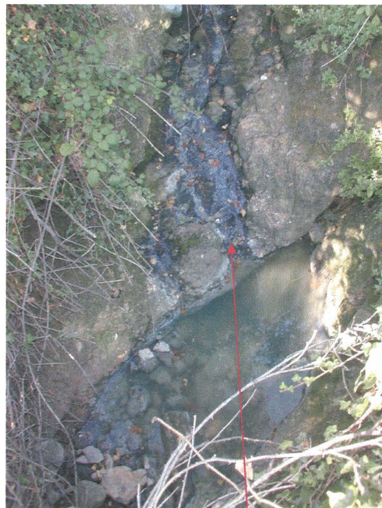
Traces d'eaux usées à l'exutoire du Ø 400 Eaux Pluviales lotissement La Celle
