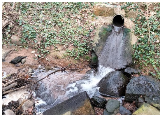
Figure 4: Exutoire de la STEP
