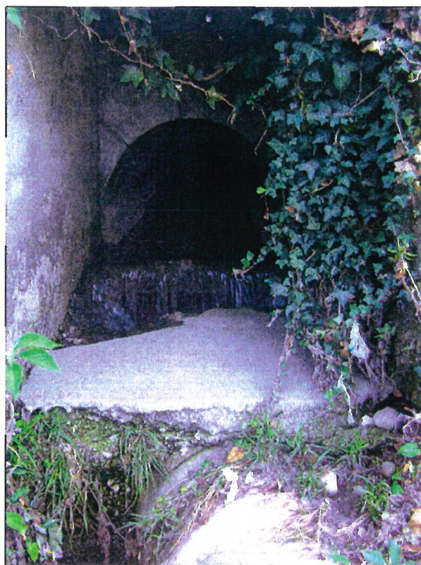
Deversoir d'orage sur l'avenue de Lyon Localisation : Peronnas
