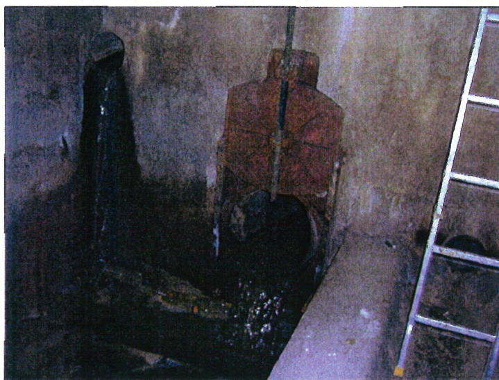
Deversoir d'orage rue du bief de l'étang localisation: Peronnas
