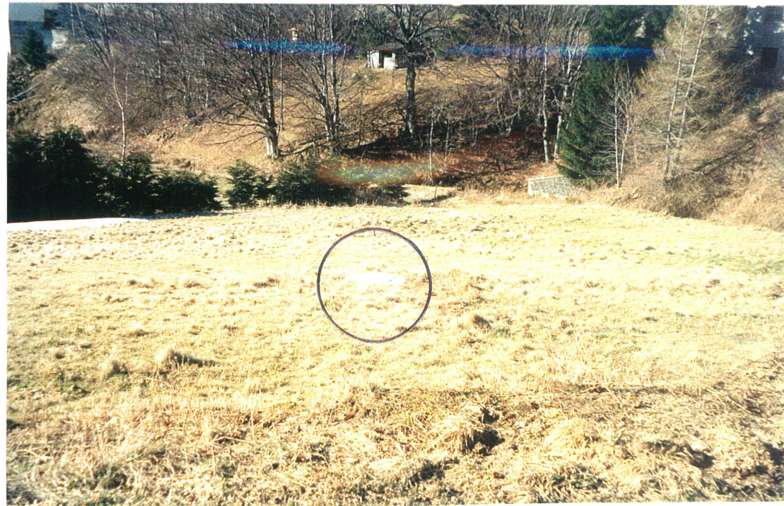
Photo 8, regard de visite non étanche
