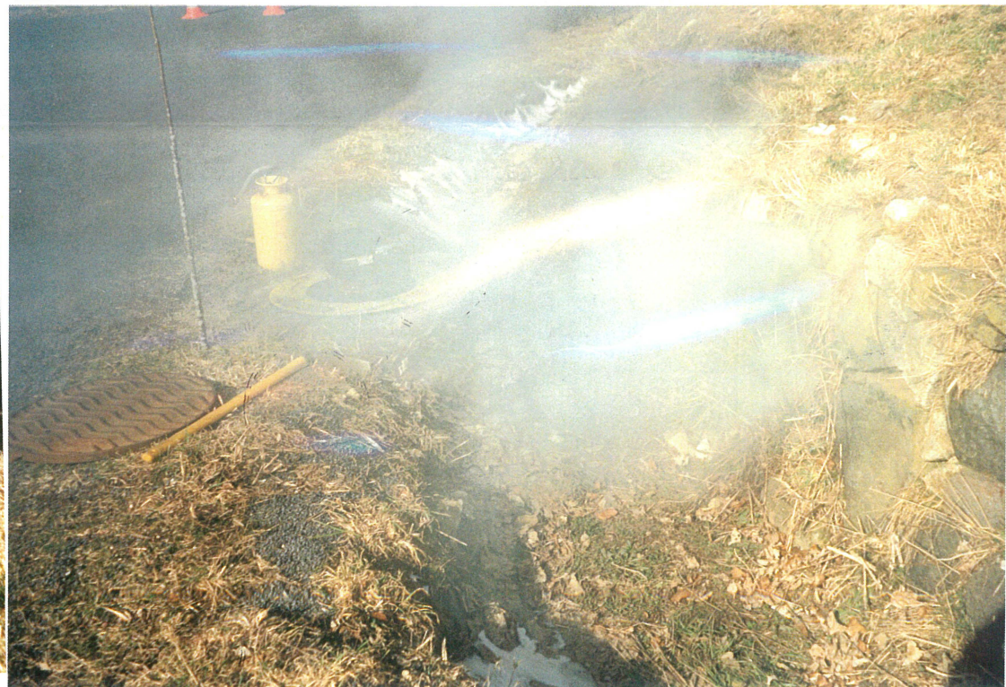
Photo 10, Boite de branchement non étanche dans un fossé
