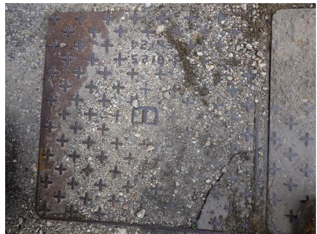
Tampon cassé – Rue du Marquis – ID 627
