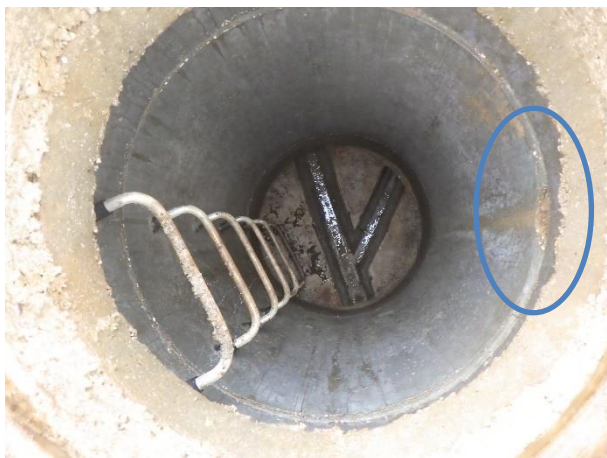
Cheminée cassée avec traces d'infiltration – La Combe, Corcelles – ID 252
