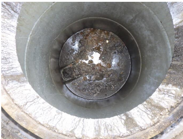
Dépôts et stagnation des effluents – Rue du Maquis – ID 175
