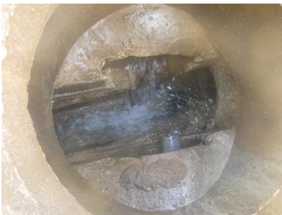
Regard n°240 – Intrusion d'eaux claires en provenance de la parcelle AD 0301
