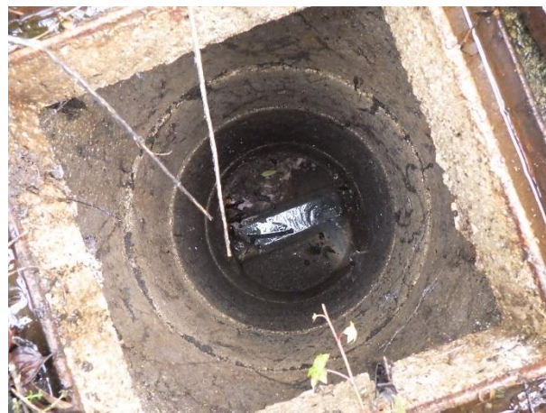
Pénétration de racelles dans la cheminée – Rue du Crétet – ID 249
