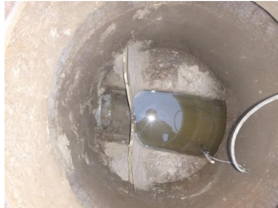
Mesure de débit sur seuil au droit du réseau unitaire
