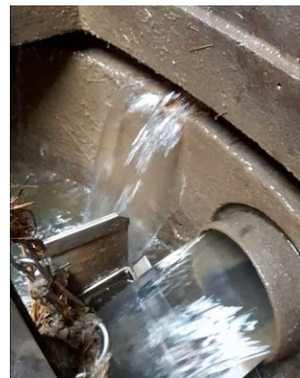
Deux intrusions d'eaux claires au niveau de la réhausse du poste de refoulement des Orchidées
