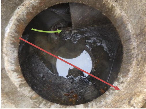
DO 1 – Vue intérieure – DO encrassé
