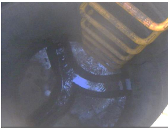
Regard n°236 – Intrusion d'eaux claires au droit du radier
