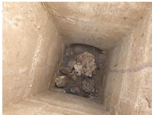
Regard sur le collecteur principal sec et avec d'importants dépôts rocheux cheminée – Route des Villages – ID 14
