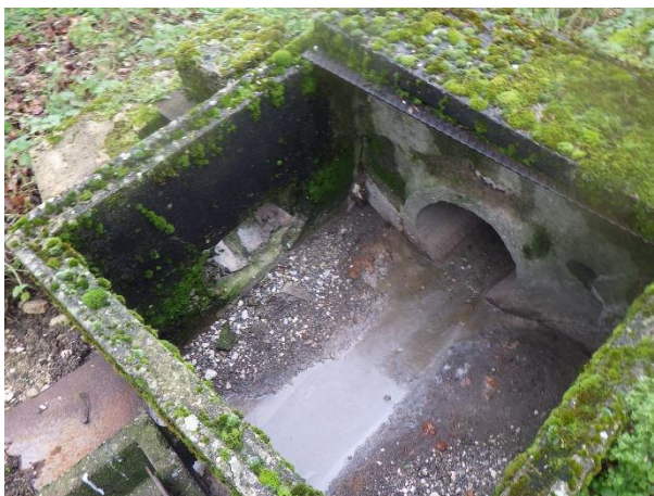
Fissures et absence d’étanchéité sur le DO amont STEP – Une partie des effluents s’exfiltre entre le regard et le canal qui suit
