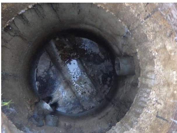
Intrusion de racines et traces de concrétions – Chemin de la Croix Peyrouse, Hautecourt – ID 98
