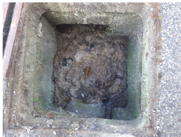
Dépôts et stagnation des effluents dans une grille – D59 Route de Neuville – ID 178
