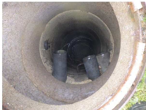
Plusieurs éléments de la cheminée sont désaxés – Puits d'infiltration de la station de Romanèche – ID 497
