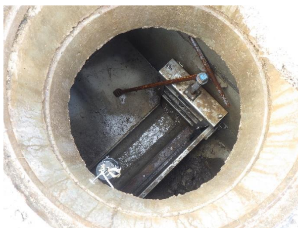
Suivi des déversements du DO de Hautecourt
