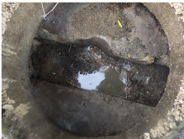
Dépôts, stagnation des effluents et racines – La Treille – ID 475
