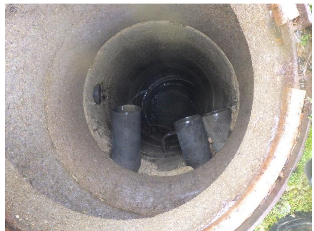
Plusieurs éléments de la cheminé sont désaxés – Puits d’infiltration de la station de Romanèche – ID 497
