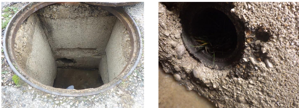
Suivi des déversements du DO de Challes
