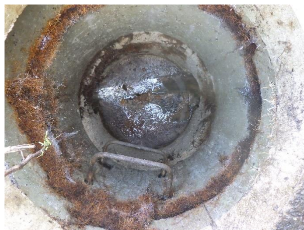
Intrusion de racines dans la cheminée – Derrière la salle polyvalente – ID 187
