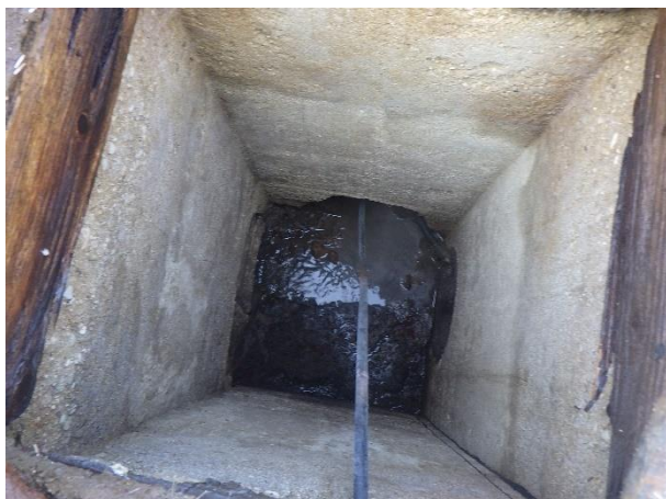
Réseau traversé par une gaine – ID 979 Route de Nantua – ID M1
