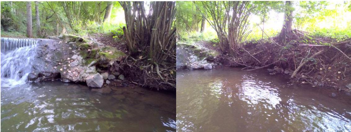
Figure 8: Affouillement visible en aval du seuil rive gauche
