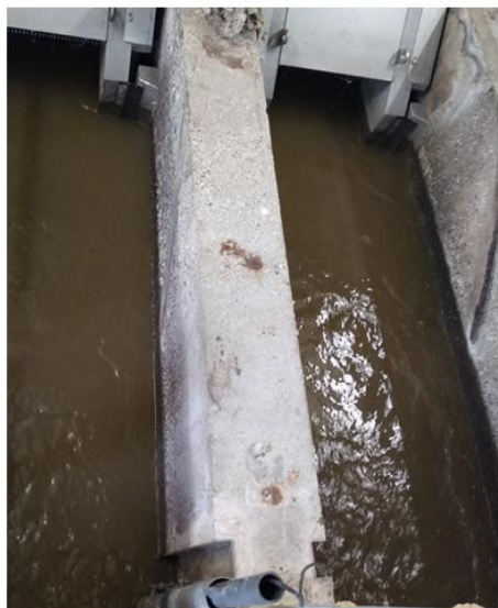
Emprise du béton visible, absence de revêtement au niveau des dégrilleurs
