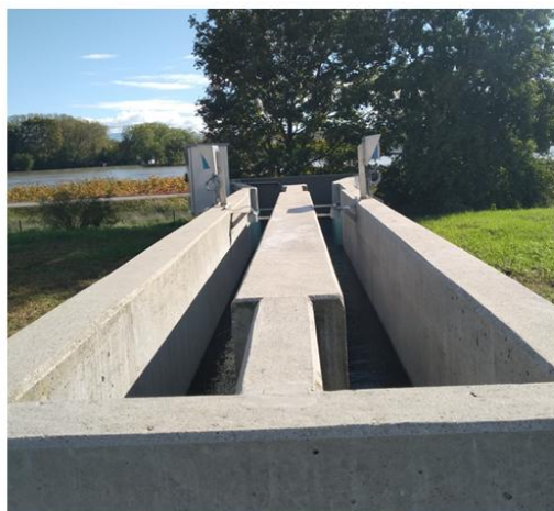
Canal de sortie
