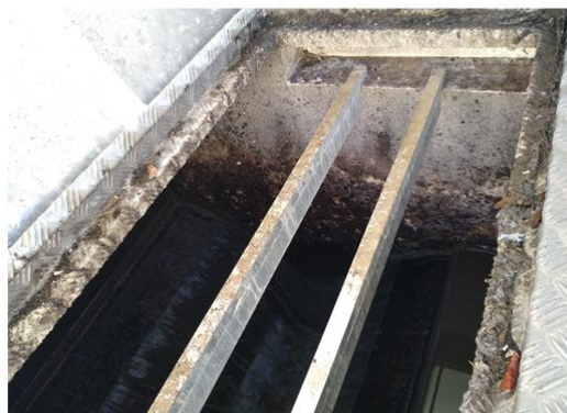
Chute d'eau usées avec projections, GC dégradé
