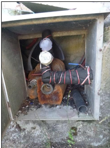
Photo 135 : Vanne de vidange en bout de réseau Saint GEORGES
