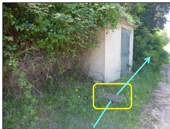
Photo 69 : Compteur n°51 (point de vente d'eau pour le fort militaire par la commune de GROSSETO PRUGNA)
