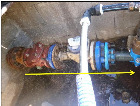
Photo 58 : Compteur n°42 « Lot Punta di Vescu » (point de vente d'eau à la commune de GROSSETO PRUGNA par l'OEHC)
