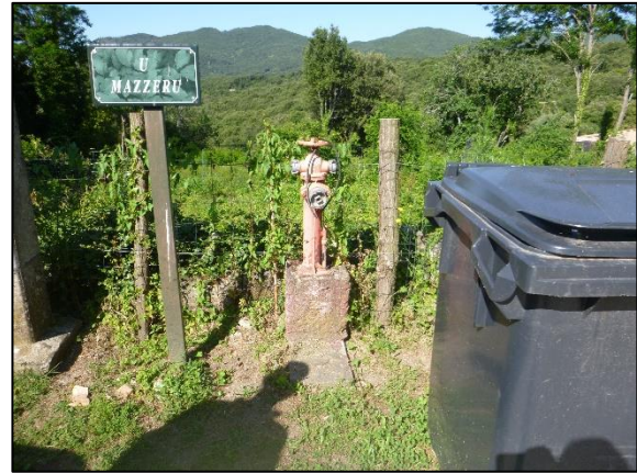
Photo 145 : Poteau incendie n°124, PRUGNA
