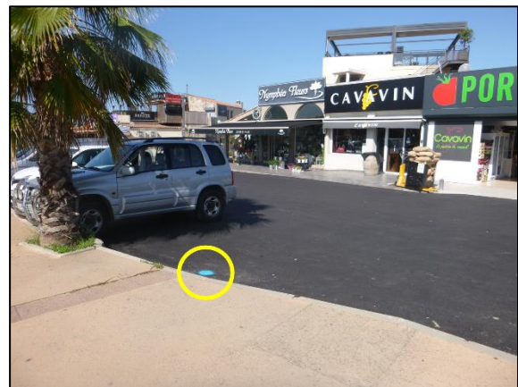
Photo 23 : Vanne de sectionnement
