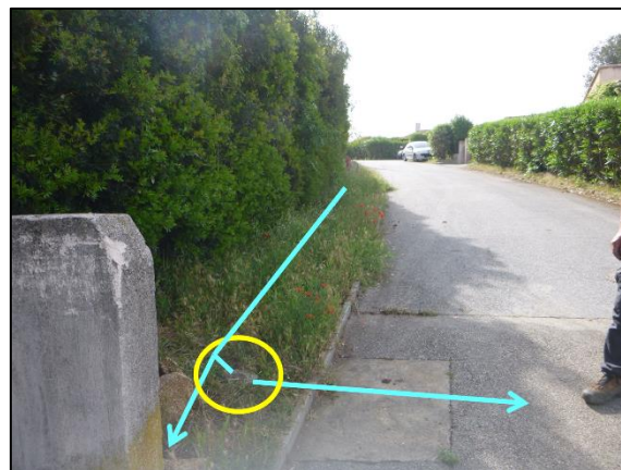
Photo 100 : Vanne vers TERRA BELLA (commune de GROSSETO PRUGNA)
