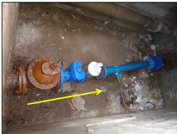
Photo 91 : Compteur n°72 « Lot Hauts Résidence » (point de vente d'eau à la commune de GROSSETO PRUGNA par l'OEHC) vers station de pompage du Golfe et distribution gravitaire
