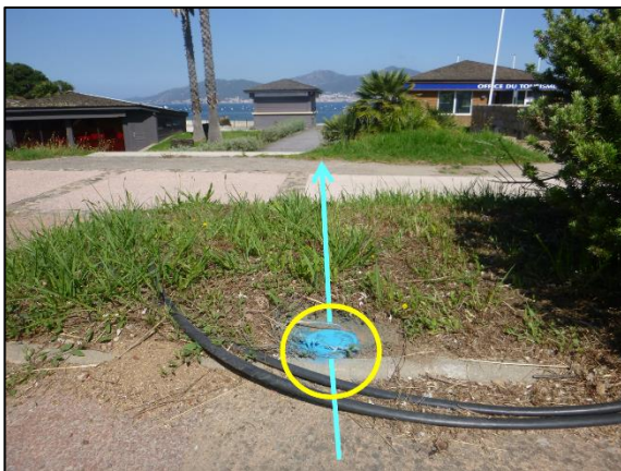
Photo 28 : Vanne de sectionnement (OEHC)
