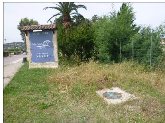
Photo 18 : Vanne dans regard (commune de GROSSETO PRUGNA)
