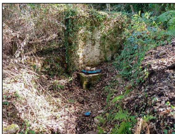
Photo 7 : Regard de captage de la source de PIAZELLI (TPAe, 11/08/2022)
