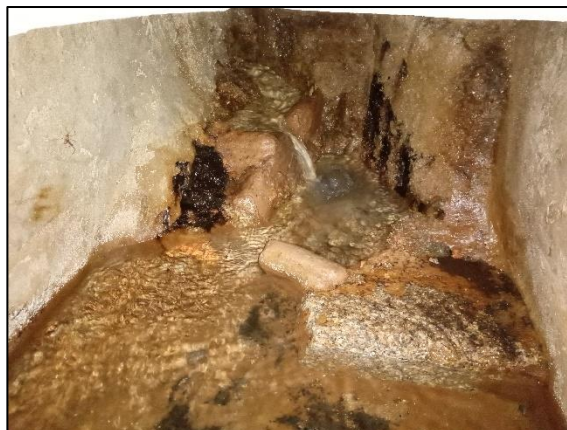
Photo 5 : Intérieur du regard de captage de la source de PIAZELLI (TPAe, 11/08/2022)
