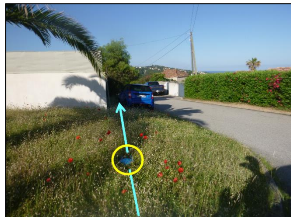
Photo 92 : Vanne de sectionnement (commune de GROSSETO PRUGNA)
