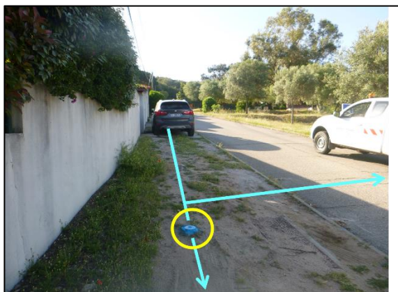
Photo 93 : Vanne de sectionnement (commune de GROSSETO PRUGNA)
