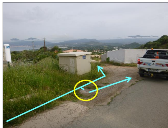
Photo 131 : Vanne de sectionnement branche droite PEHD 63, secteur BOMORTU (Commune de GROSSETO PRUGNA)
