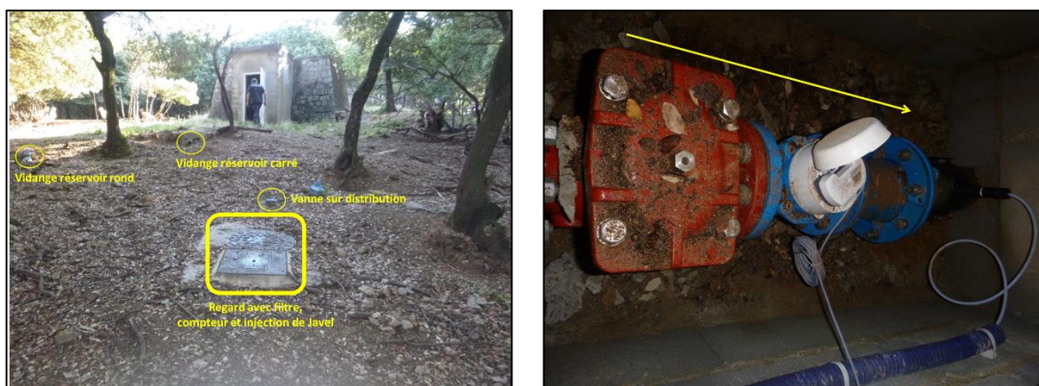
Photo 24 : Equipements en aval des réservoirs de GROSSETO (TPAe, 23/06/2020)
