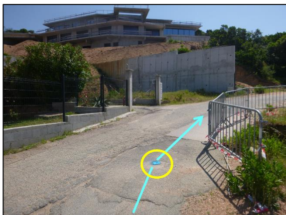
Photo 68 : Vanne de sectionnement (commune de GROSSETO PRUGNA)
