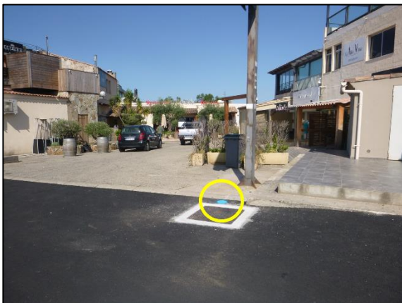
Photo 24 : Vanne de sectionnement individuelle
