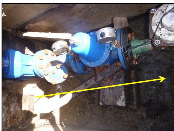
Photo 108 : Compteur n°85 (point de vente d'eau à la commune de GROSSETO PRUGNA par l'OEHC) au bénéfice de la Résidence CALIFORNIA
