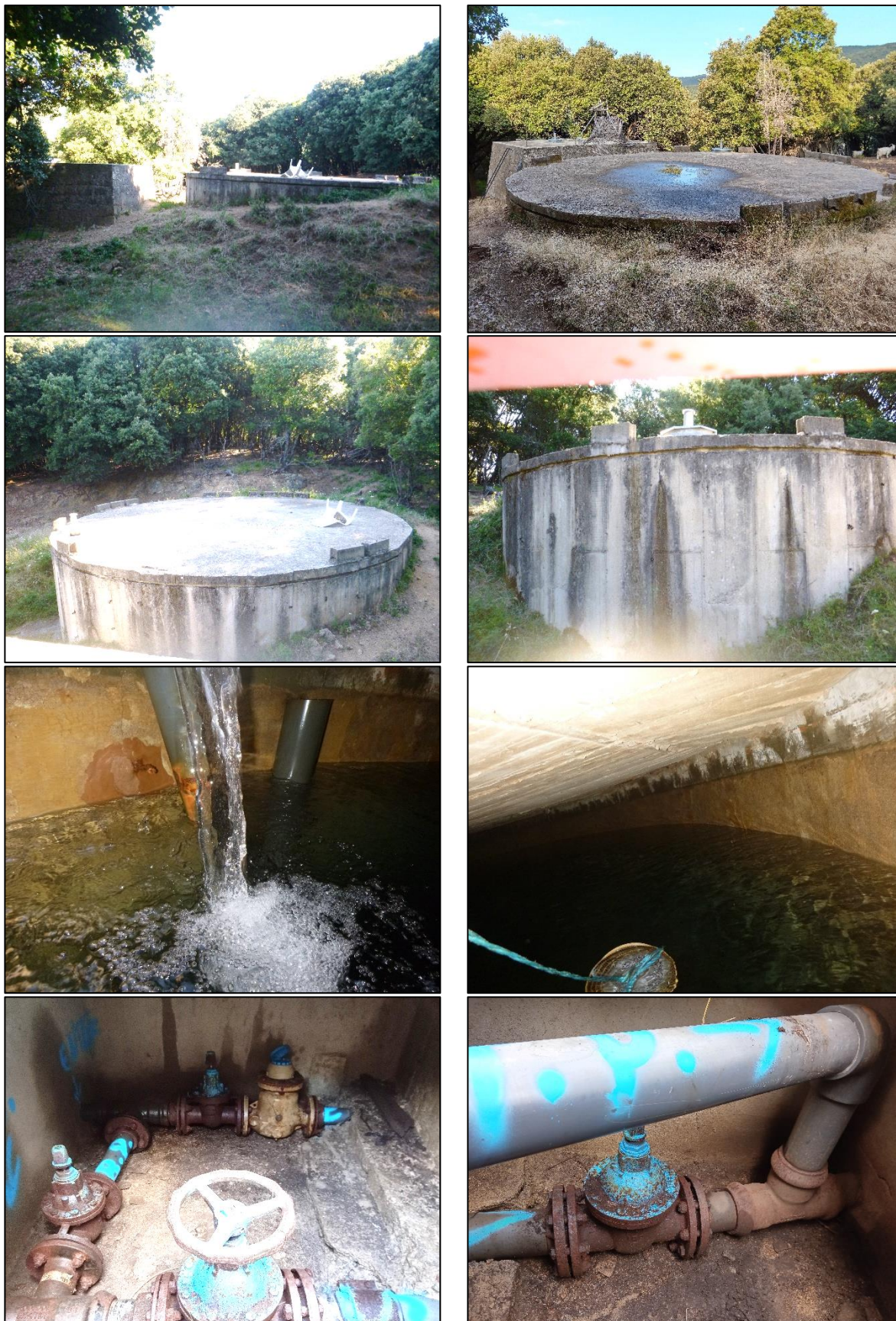
Photo 22 : Réservoir de GROSSETO rond (TPAe, 23/06/2020 et 11/08/2022)
