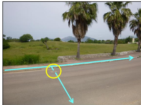
Photo 6 : Vanne communale vers résidence privée
