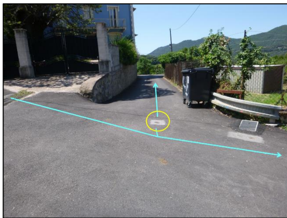
Photo 139 : Antenne et vanne de sectionnement GROSSETO
