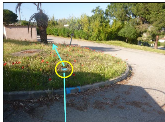
Photo 94 : Vanne de sectionnement (commune de GROSSETO PRUGNA)
