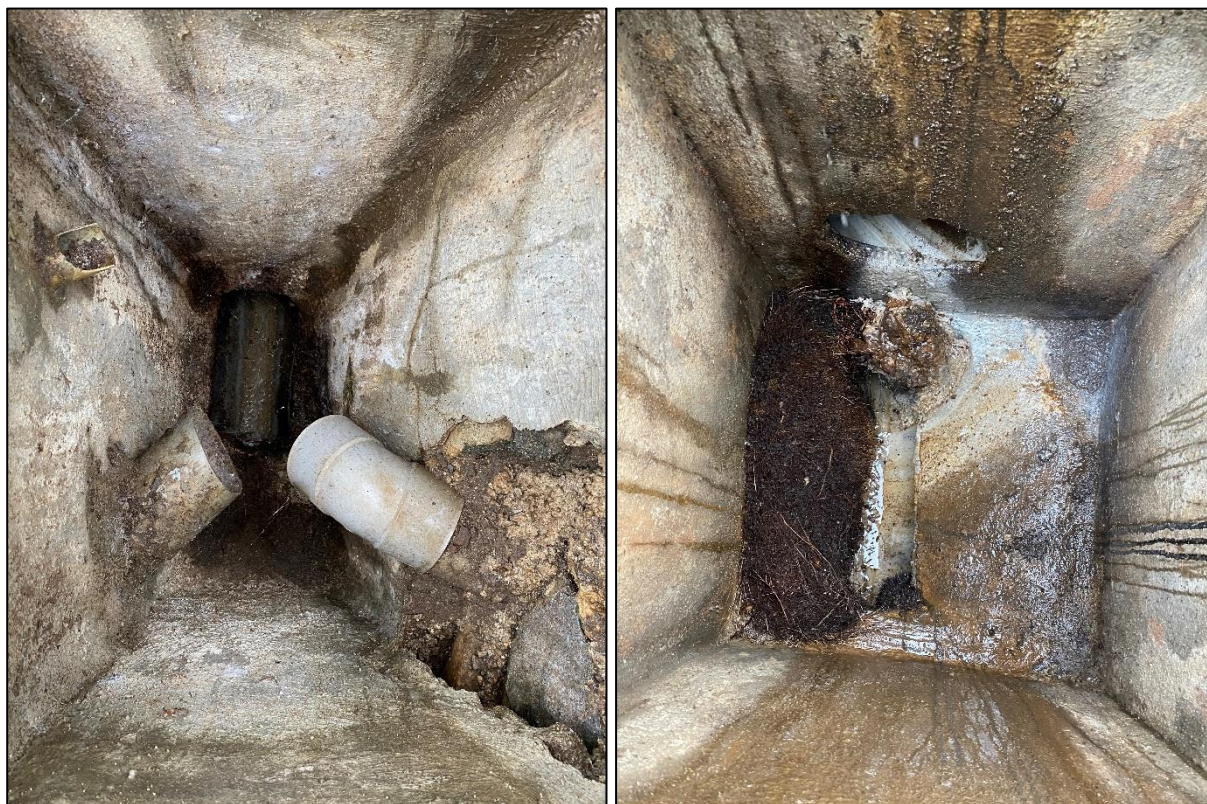
Figure 9 : Photographies des dysfonctionnements observés au niveau des regards du réseau d'assainissement
