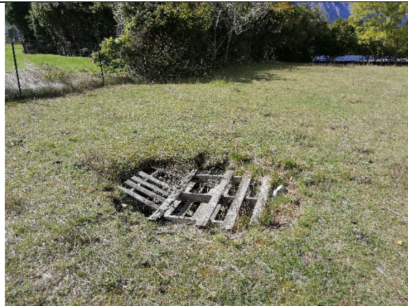
Figure 54 : Effondrement de galerie au WP383
