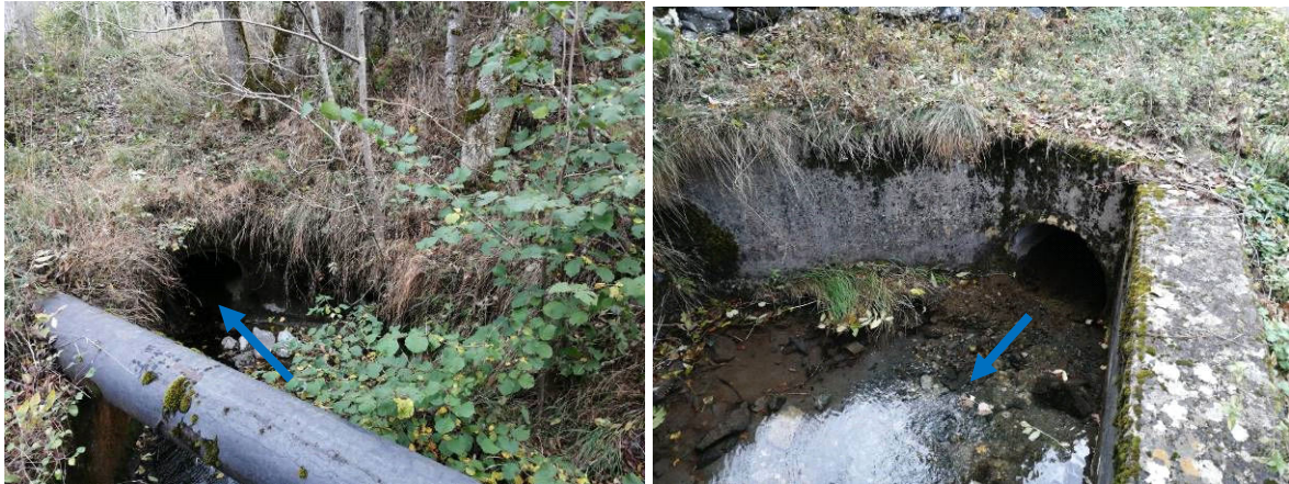
Figure 29 : Entrée et sortie buse DN800 dans le canal
