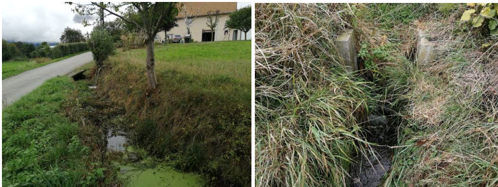
Figure 19 : Ponceaux et prises
