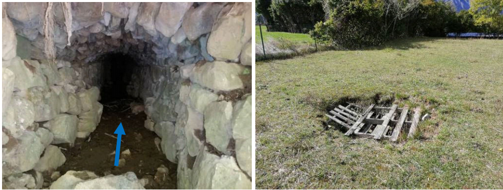
Figure 41 : Passage voûté et effondrement
