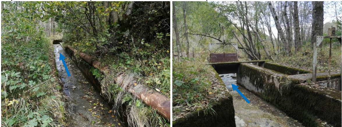
Figure 28 : Buse DN350 en acier et martelière de rejet dans la rivière
