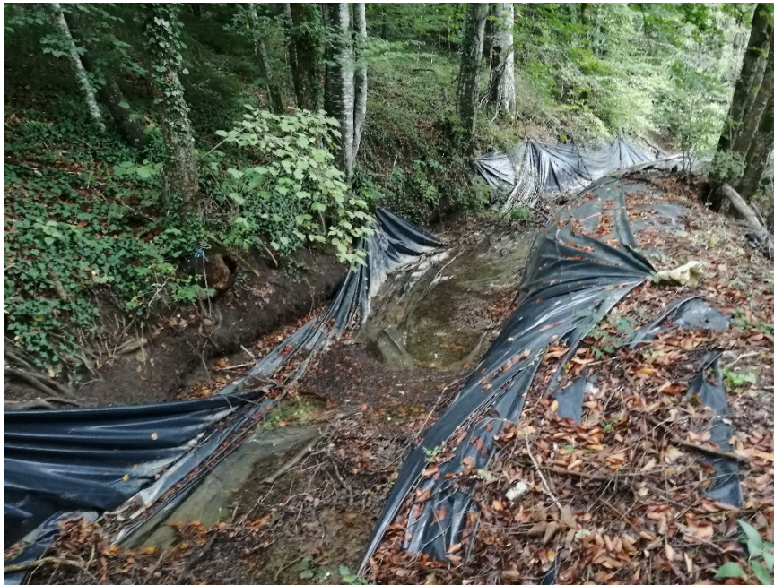
Figure 53 : Bâche dégradée au droit du glissement
