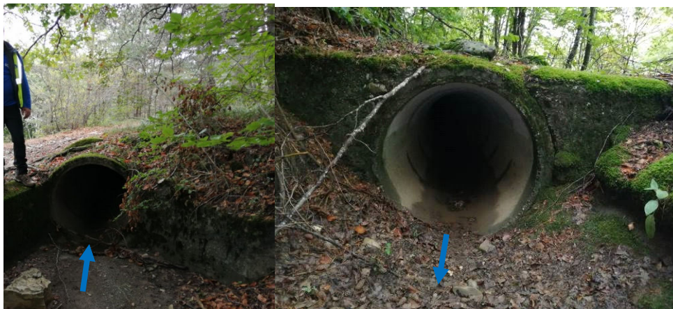
Figure 15 : Entrée et sortie buse DN1000
