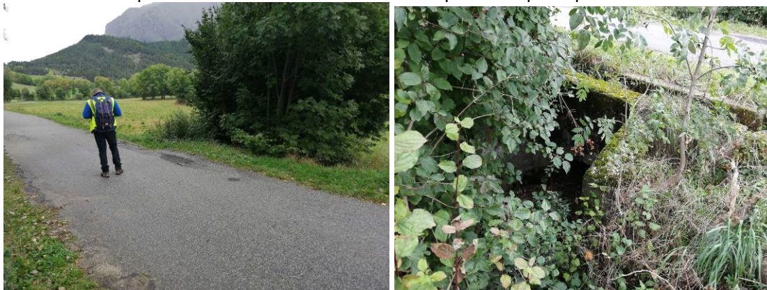
Figure 12 : Ponceau et buse DN800
