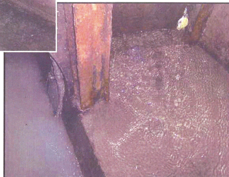
Même déversoir d'orage vu de l'intérieur avec l'intrusion du Morgon dans le réseau unitaire
