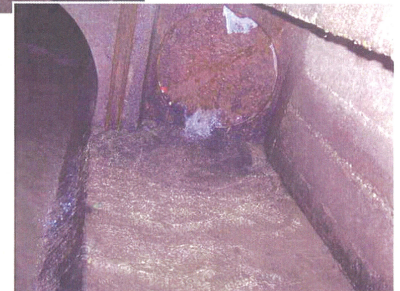
Déversoir d'orage n°23 vu de l'intérieur avec l'intrusion du Morgon dans le réseau unitaire
