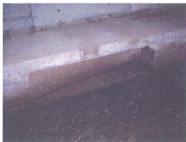
Exemple de déversoir d'orage installé sur le collecteur principal du Morgon
