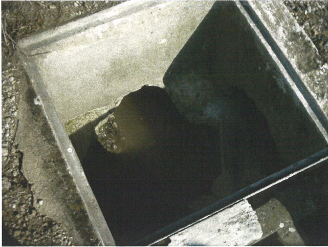
Photo 3 : déversoir d'orage à la station d'épuration
