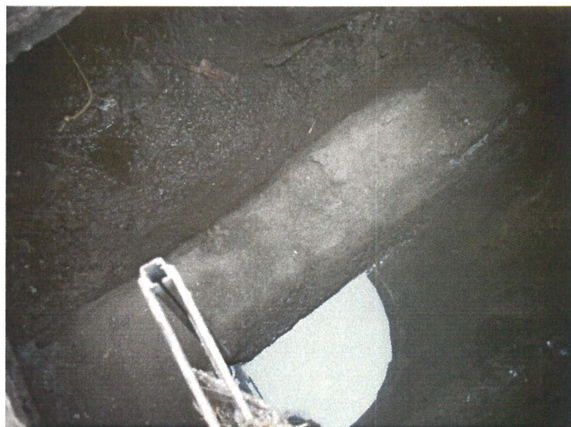
Photo 2 : déversoir d'orage place de l'Eglise
