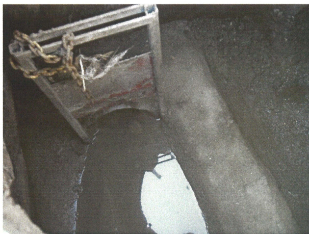
Photo 1 : déversoir d'orage place de l'Eglise
