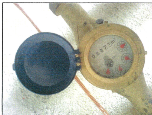
Compteur en aval des pompes
