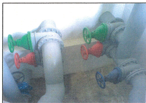
Canalisations de distribution
