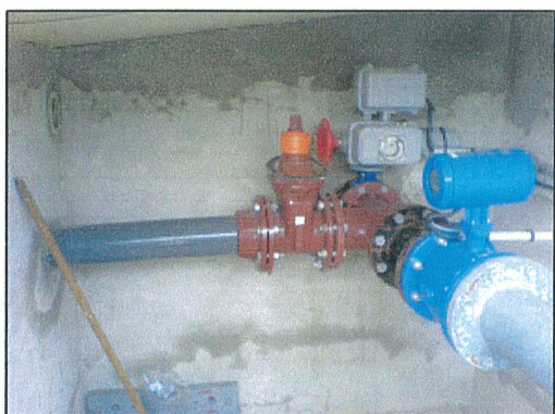
Canalisation de refoulement
