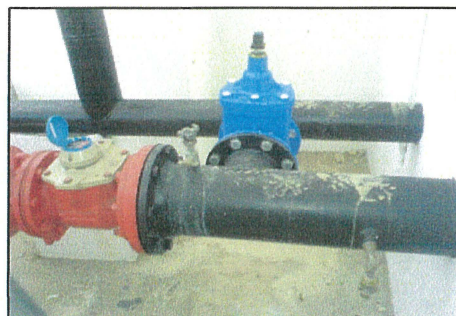
Compteur sur canalisation de distribution
