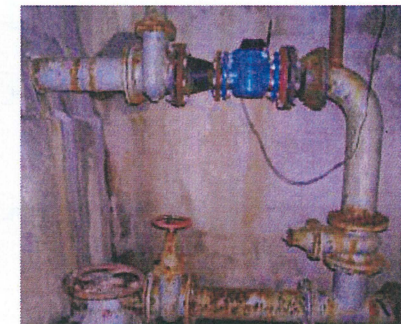
Conduite de départ
