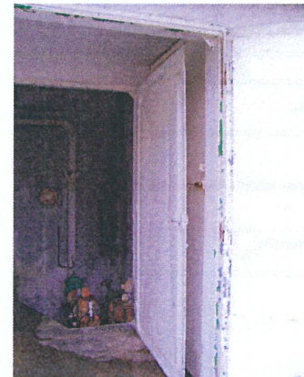
Entrée (à droite stockage chlore gazeux)
