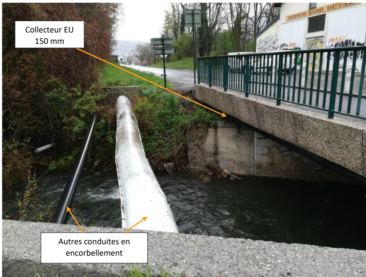
Figure 38 : Photos des collecteurs actuellement en encorbellement route d'Aprémont
