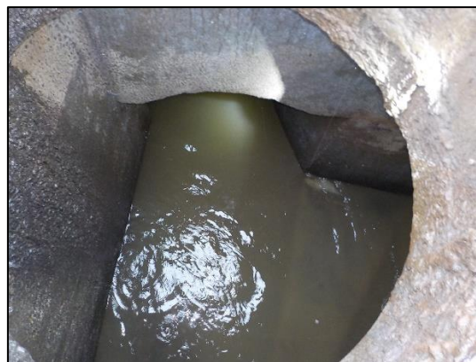
Figure 22 : Regard de jonction 17 (cf photo précédente) – réseau non saturé
