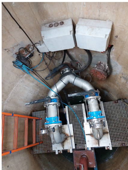
FIGURE 28 – COFFRETS ELECTRIQUES DANS LE Puits DU RECOLON
