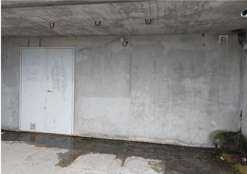
FIGURE 26 – PORTE DU SURPRESSEUR
