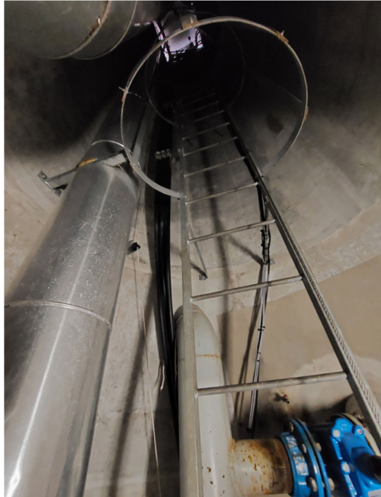
FIGURE 25 – CRINOLINE D'ACCES A LA CUVE DU RESERVOIR
