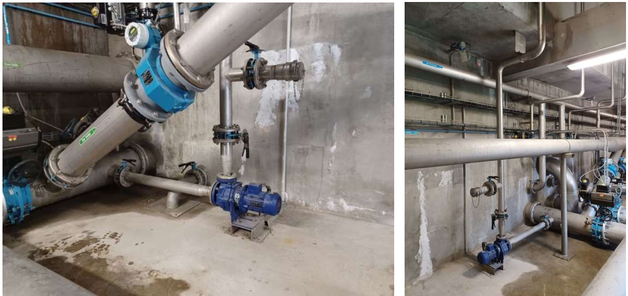
Figure 146 - Pompes et réseau de recirculation
