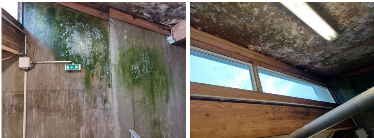
Figure 150 - Problématique de ventilation / déshumidification
