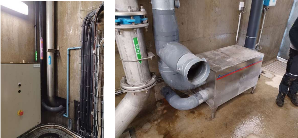
Figure 151 - Réseau divers / Installation de déshumidification
