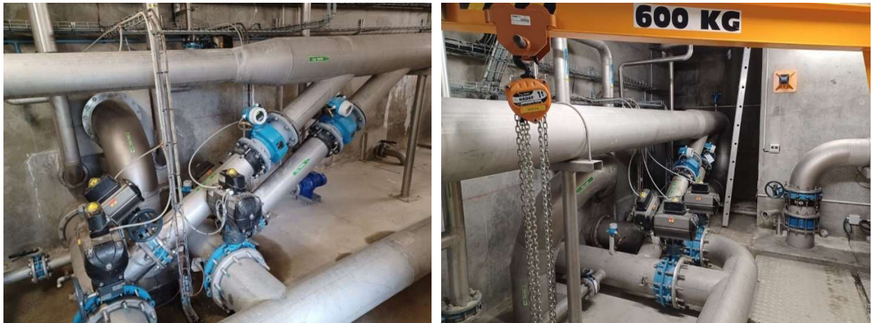
Figure 141 - Hydraulique en sortie de filtres
