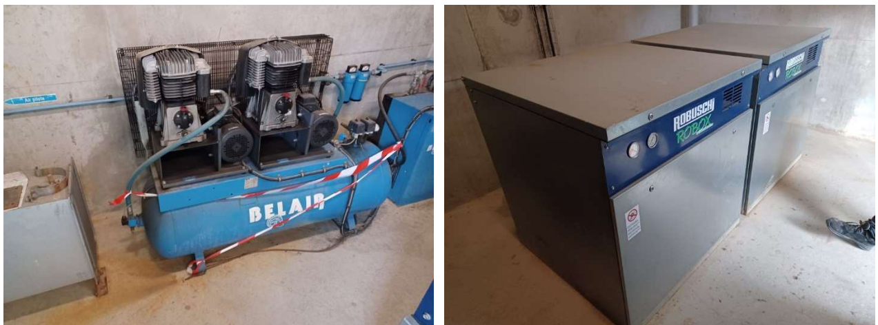
Figure 147 - Compresseur Air comprimé / Surpresseur Air Process
