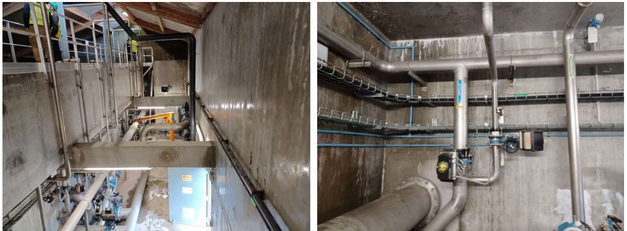
Figure 140 - Vue d'ensemble de la galerie des filtres
