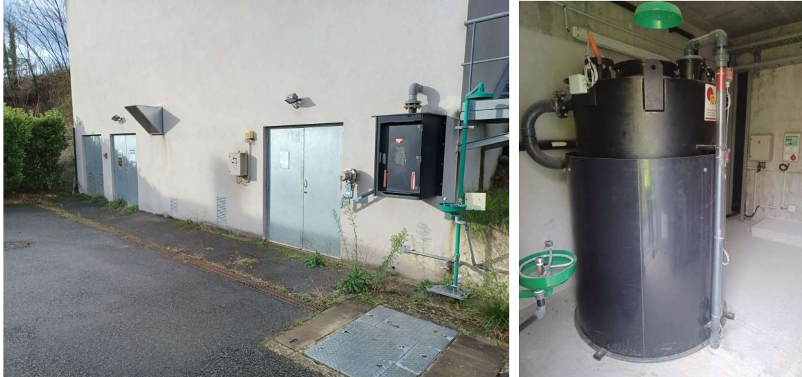
Figure 149 - Aire de dépôtage / Cuve de stockage de Soude (hors service)
