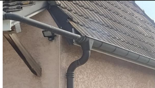
2 - Identification de tous les organes laissant s'échapper la fumée
