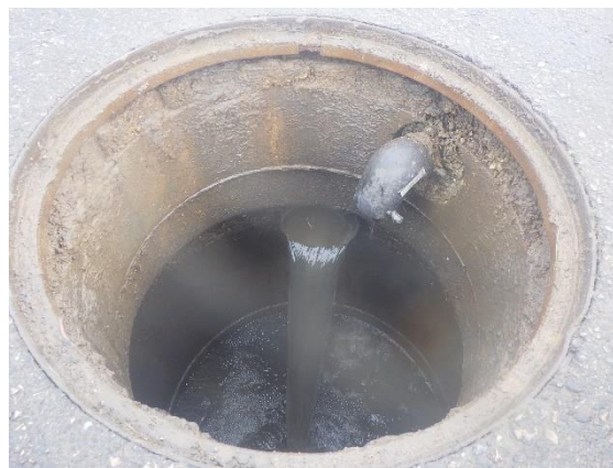
Eaux pluviales du fossé entrant par le trop plein – Regard n°20 – Pont-de-Vaux – vue intérieure
