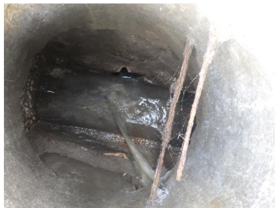
Dégradation H 2 S – Regard n°551 – Feillens – vue intérieure
