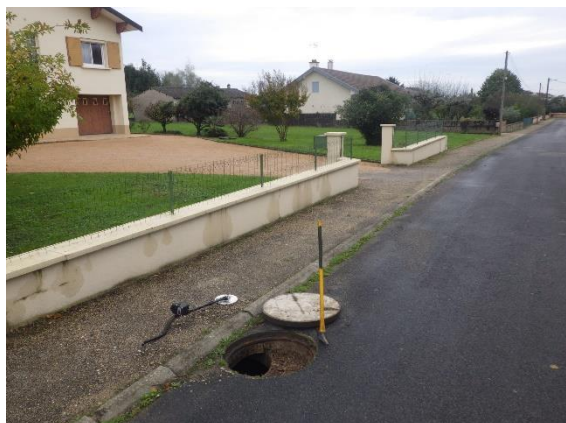
Couronne décalée – Regard n°40 – Manziat – vue extérieure
