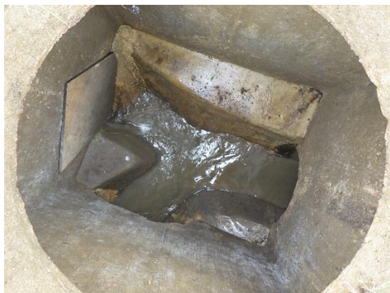
Obstruction non étanche – Regard n°314 – Manziat – vue intérieure
