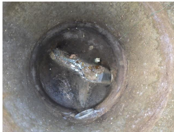
Absence de cunette – Regard n°366 – Pont-de-Vaux – vue intérieure
