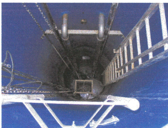
Fig. 3-e : Vue de la bâche du poste de refoulement (PR 2)
