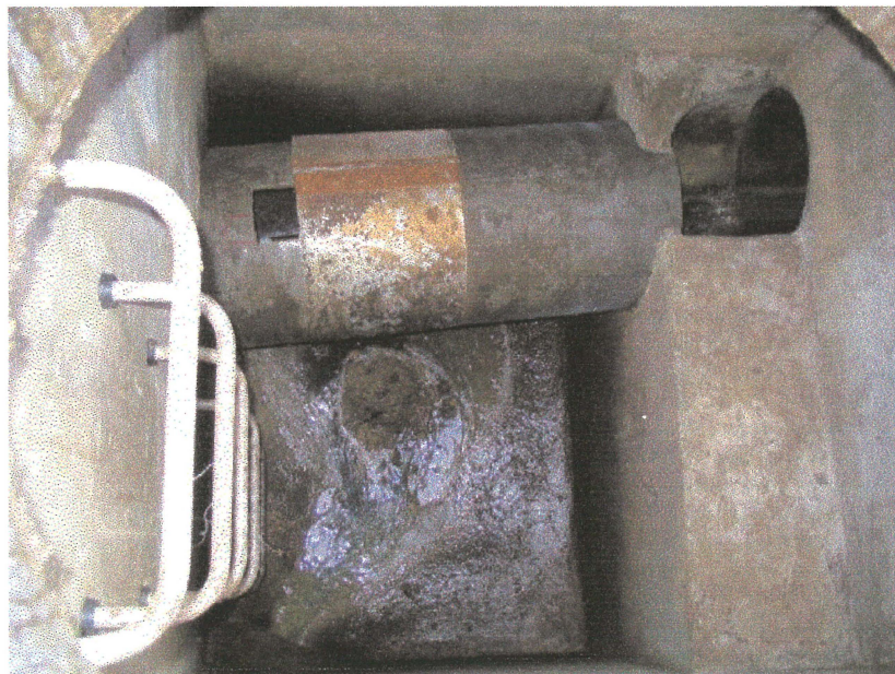
Fig. 3-a : DO1 : montée de la rue du Village, réseau unitaire
