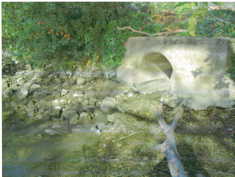
Fig. 3-b : exutoire dans le Rhône du réseau pluvial sollicité par le DO1 (photo sept 2004)
