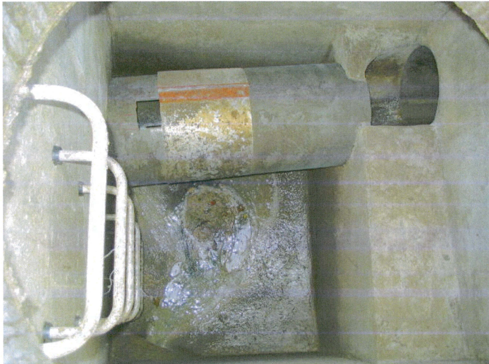
Fig. 3-a : le déversoir d'orage DO1
