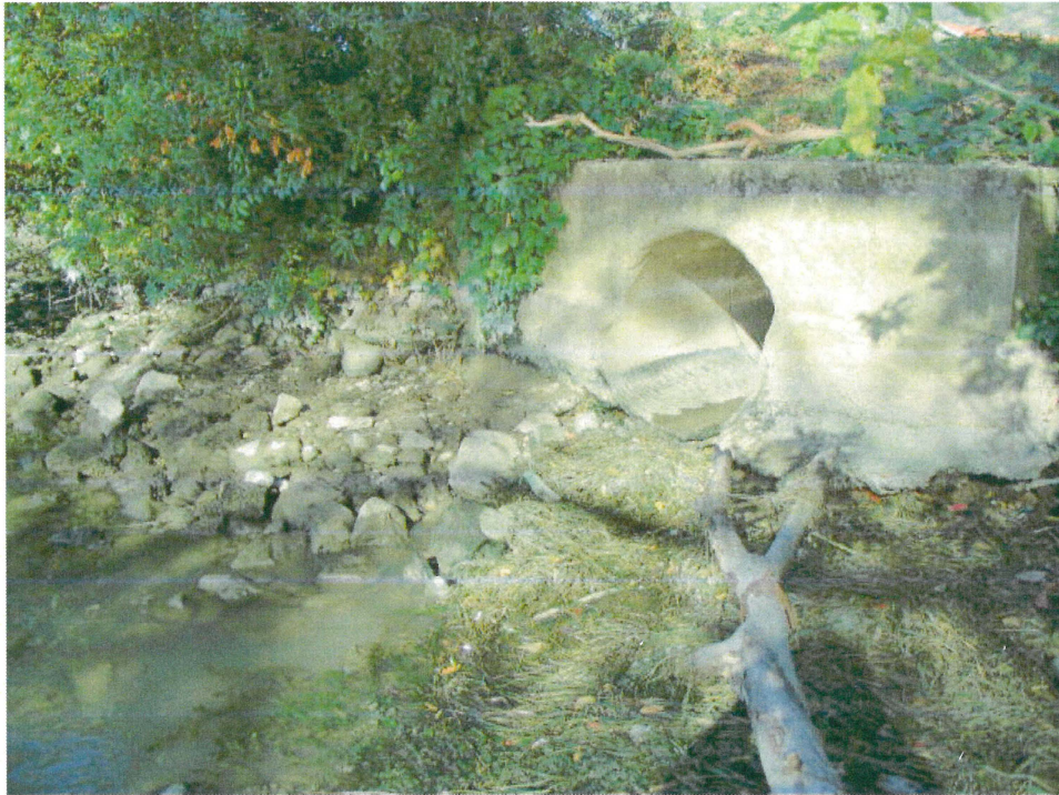
Fig. 4-b : exutoire dans le Rhône du réseau pluvial sollicité par le DO1 (photo sept 2004)
