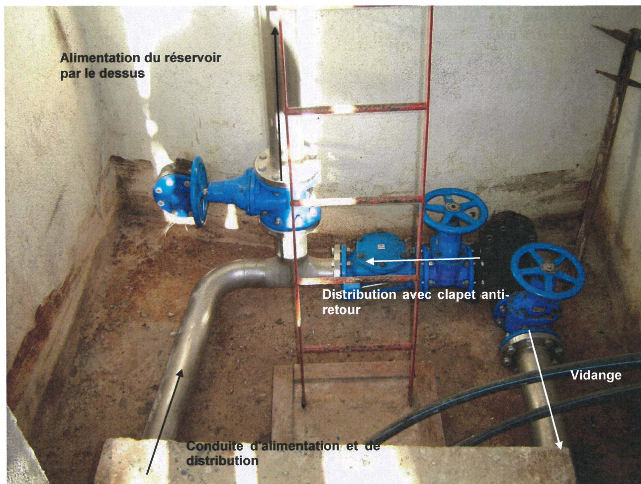
Chambre de vanne du réservoir Chadafaux
