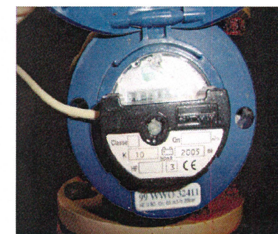
Compteur du trop plein
