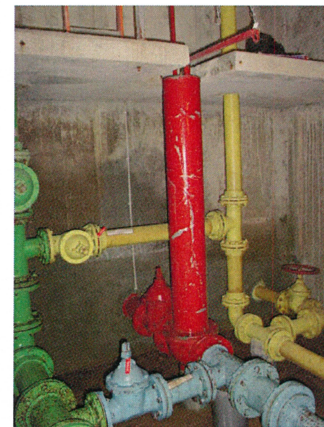
Distribution, réserve incendie
