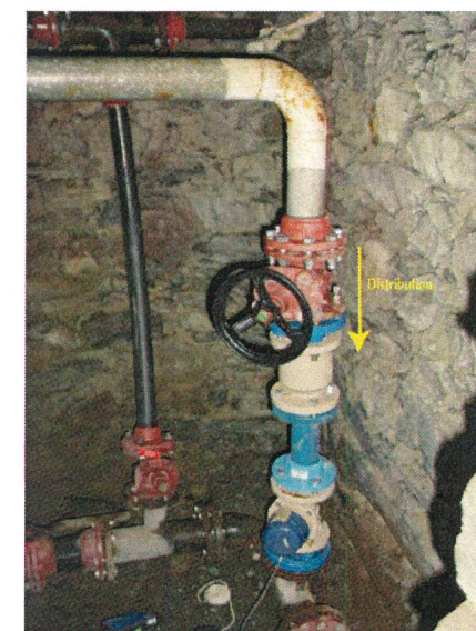
Distribution, réserve incendie
