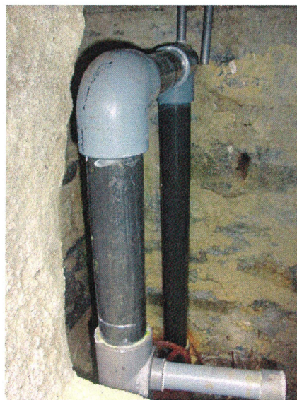
Distribution, réserve incendie
