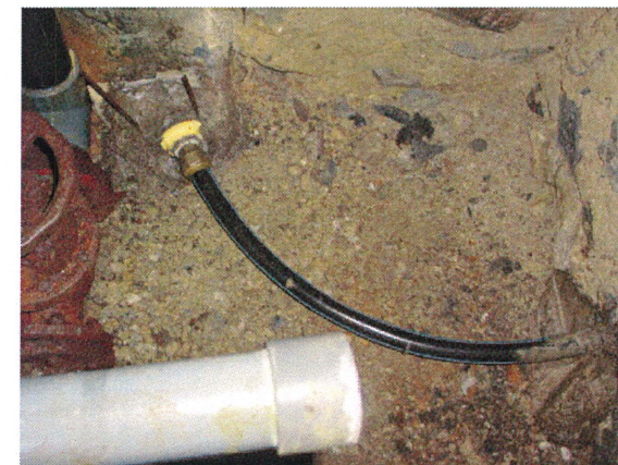
Branchement du bassin en contrebas du réservoir
