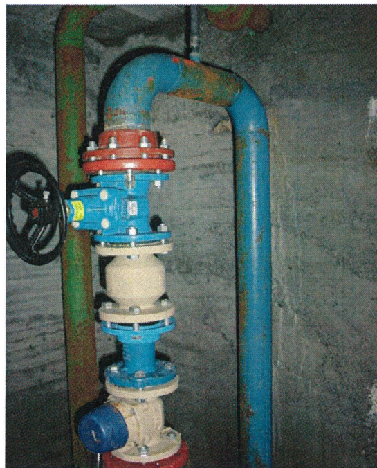
Distribution, réserve incendie
