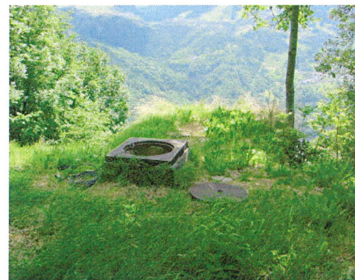
Accès par regard
