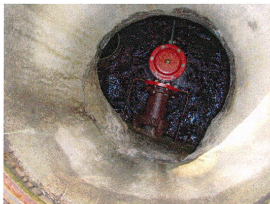
Arrivée trop-plein de Bozel Haut
