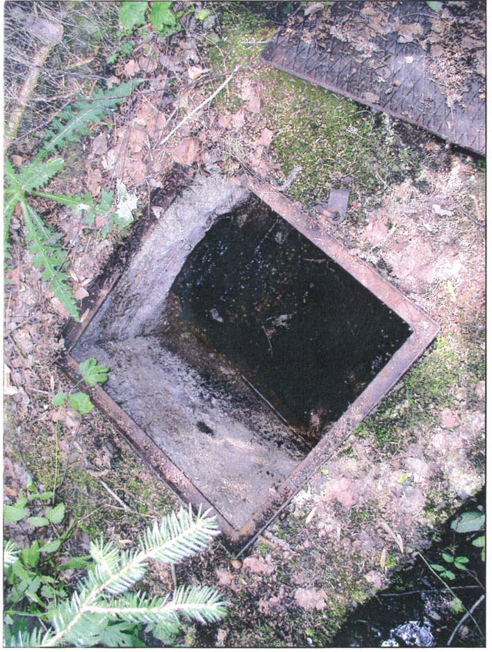
POINT D'EAU n°39 : Captage de L'Epine
