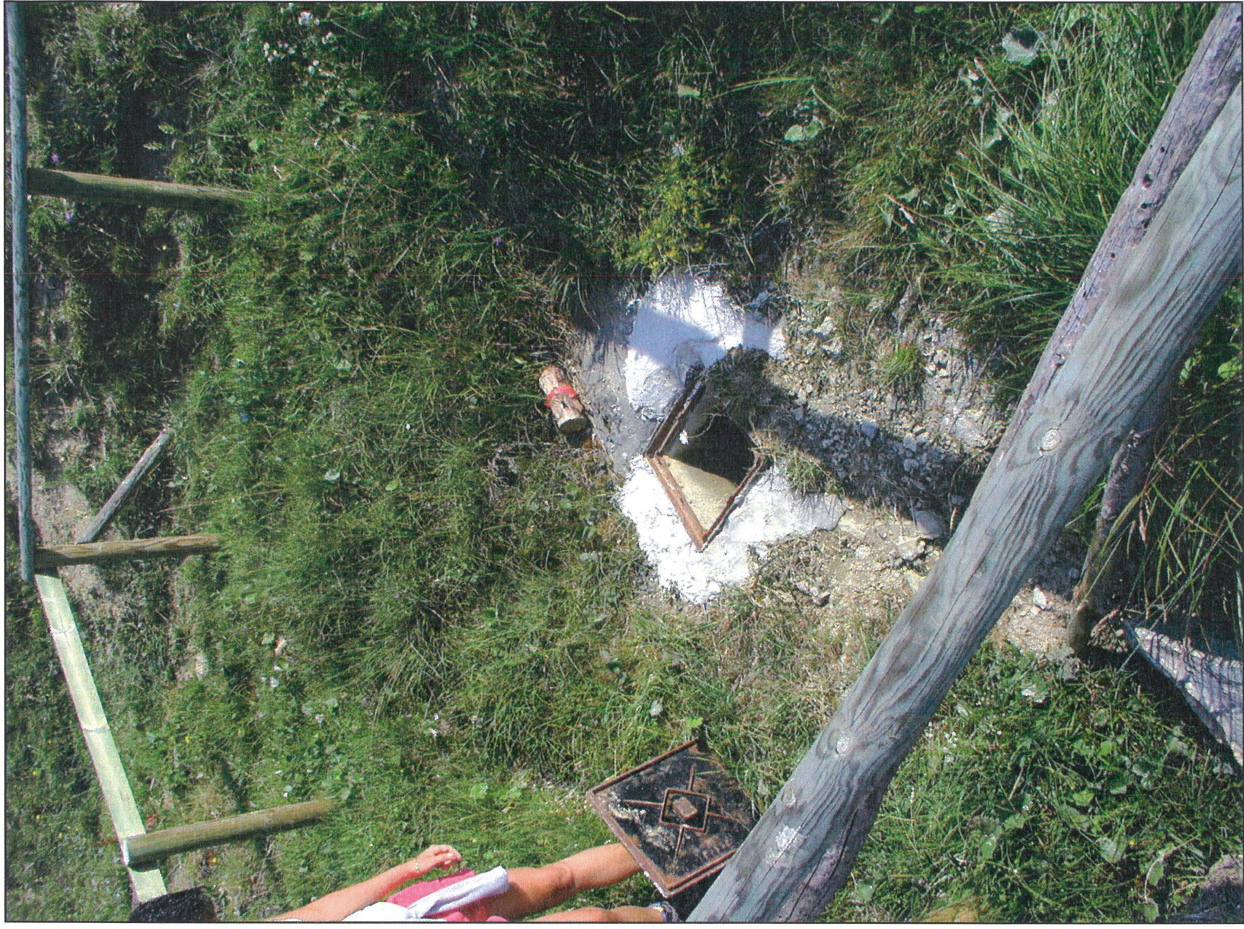
POINT D'EAU n°16 : Captage du Bois des Perrières
