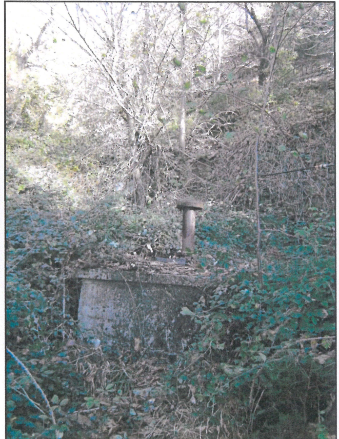
Ouvrage de réception – Source de Maleval – Novembre 2008
