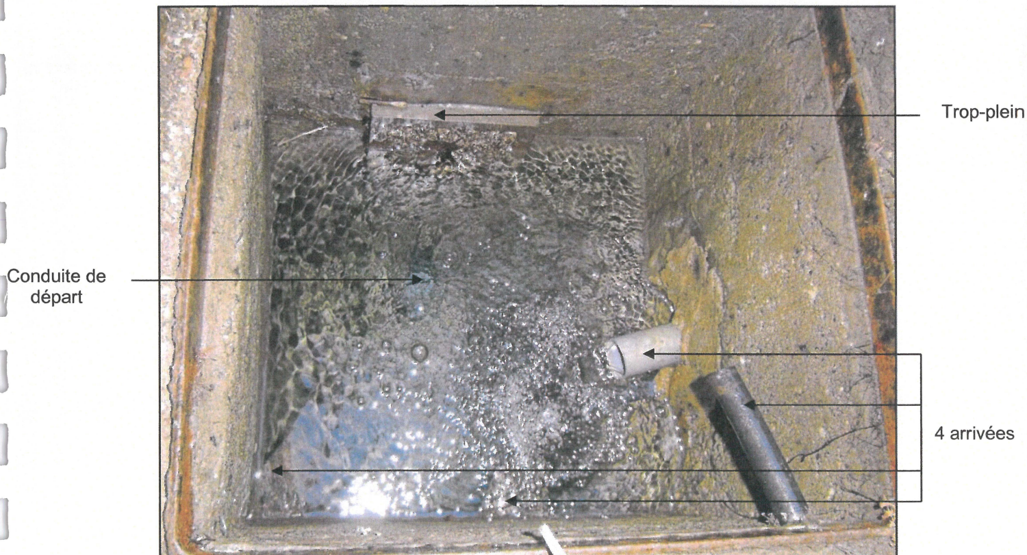
Vue de dessus de l'ouvrage de réception des trois sources - Novembre 2008
