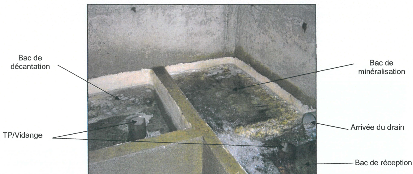
Source de La Mole - Intérieur du captage - Novembre 2008
