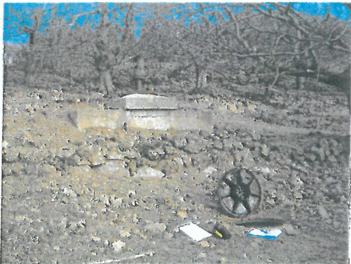
Vue extérieure de la cuve et du regard compteur
