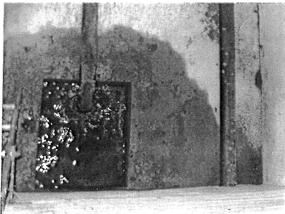
Vue intérieure de la chambre de vannes (rejet trop-plein/vidange)
