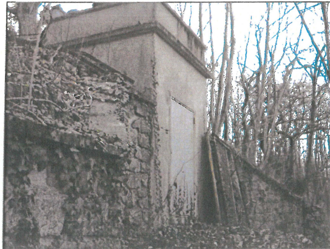
Réservoir de La Pervenche
