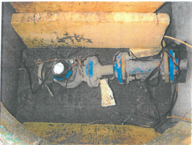
Compteur sous regard
