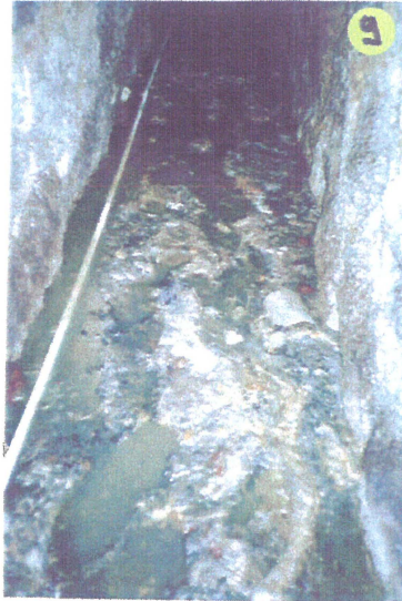
Dépôt de 20cm à 56 m
