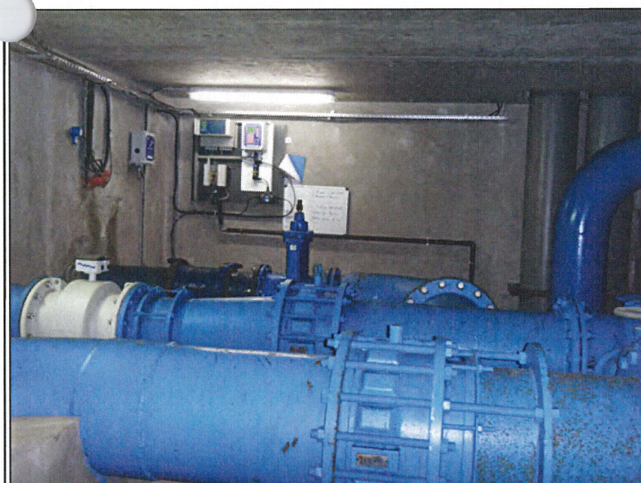
Réservoir 1 Chambre de vannes - Alimentation + Distributions
