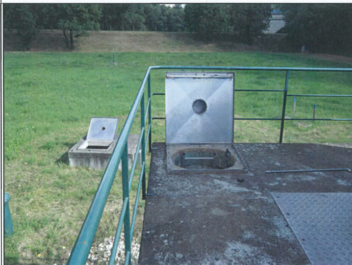
Accès Chambre de vannes + Accès Débitmètre
