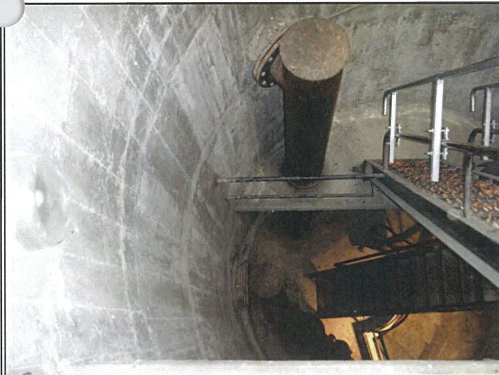
Trop Plein + Distribution avec vanne et clapet
