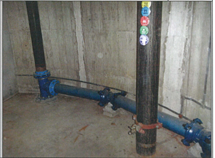
Entrée réservoir - Refoulement / Distribution + Trop Plein / Vidange
