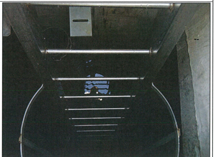
Accès à la cuve - Trop Plein
