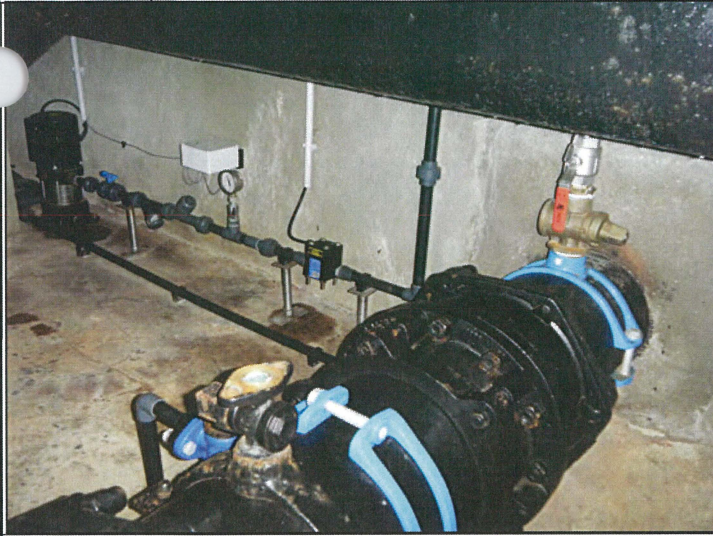
Réservoir 2 - Chambre de vannes Distribution + Chloration
