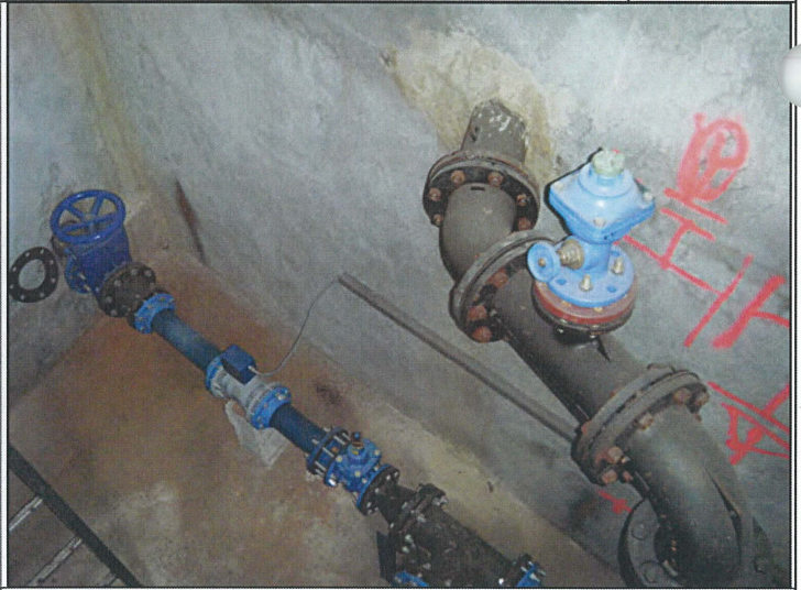
Chambre de vannes - Alimentation avec ventouse + Distribution avec débitmètre
