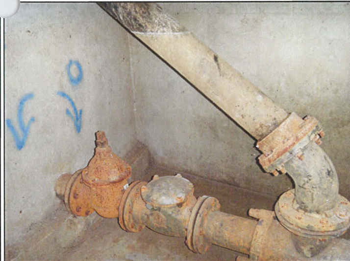
Chambres de vannes - Refoulement / Distribution
