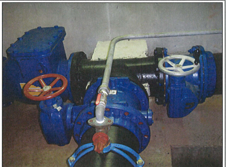
Chambres de vannes - Distribution avec clapet
