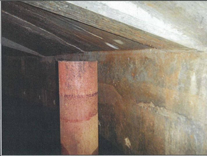
Réservoir 1 Trop Plein
