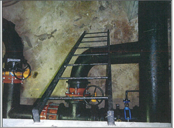
Réservoir 2 - Chambre de vannes Distribution + Alimentation + Bypass
