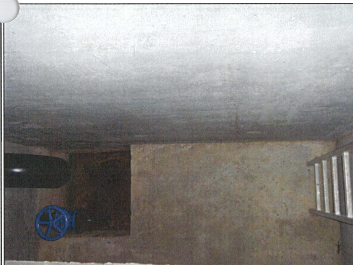
Réservoir 1 Accès Chambres de vannes - Vidange + Trop Plein
