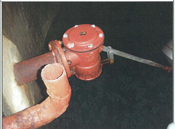
Réservoir 2 Alimentation par Robinet Flotteur + Trop Plein
