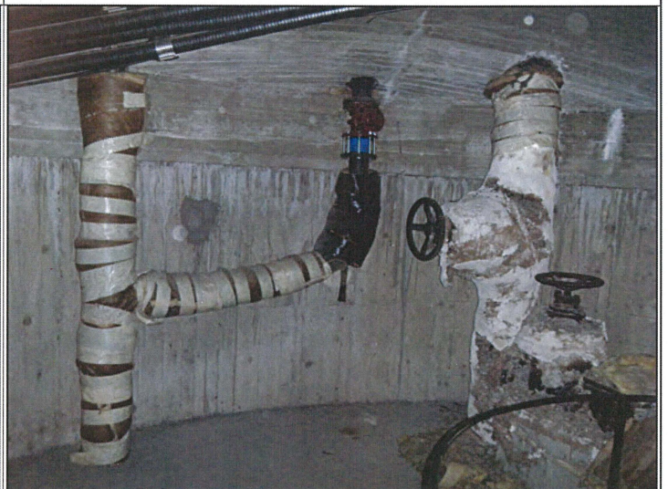
Chambre de vannes - Trop Plein + Vidange + Refoulement / Distribution
