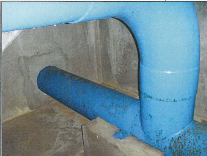
Réservoir 1 - Chambre de vannes
