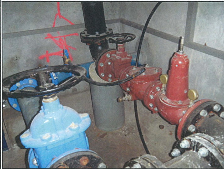
Chambres de vannes - Alimentation avec réducteur et filtre + Bypass
