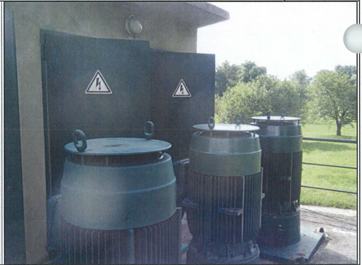
Groupes + Armoires Electriques
