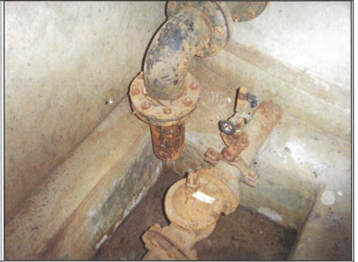
Chambre de vannes - Vidange + TROP PLEIN
