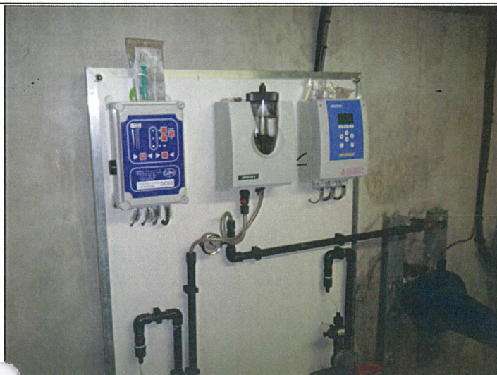
Système de chloration
