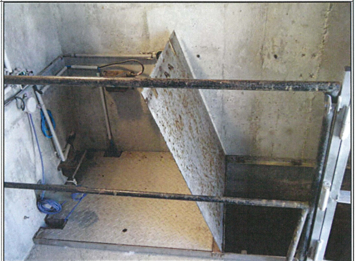
Accès cuve + Inter à flotteur + Poires de niveau
