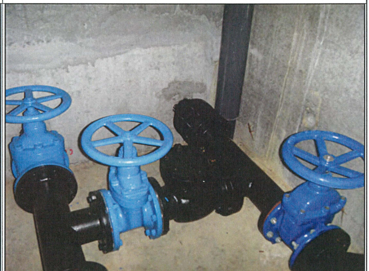
Réservoir 1 Chambres de vannes - Alimentation + Distribution + Bypass
