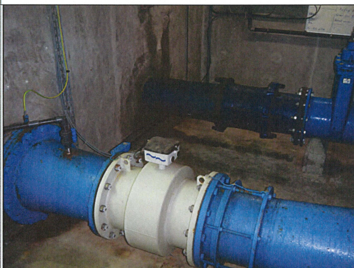
Réservoir 1 Chambres de vannes - Distributions + Débitmètre
