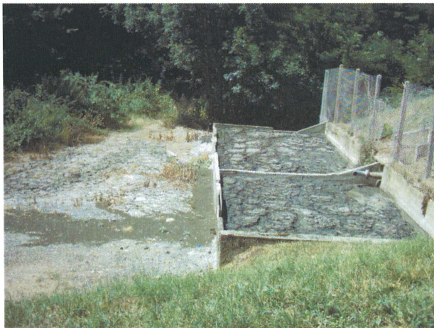
Photo 3 : Lits de séchage des boues
