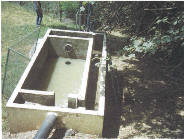
Photo 1 : arrivée des effluents en entrée de station
