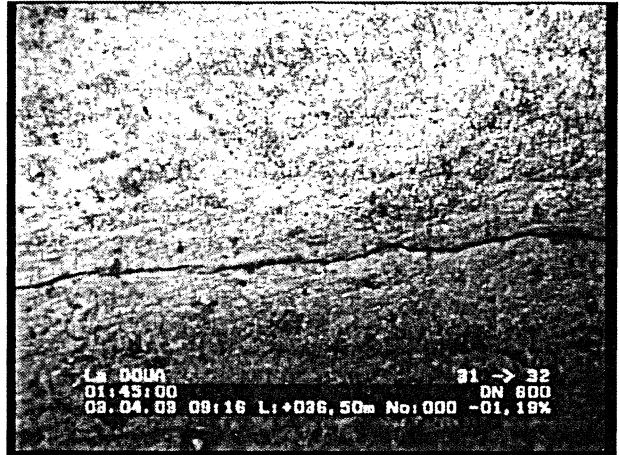
Photo: 18_3a, N° cassette: 1, 01:44:57 36,5m, Fissure transversale ouverte
