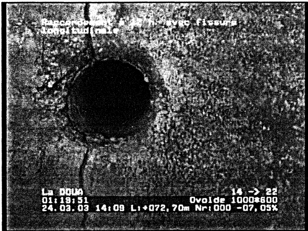
Photo: 16_6a, N° cassette: 1, 01:19:49 72,7m, Raccordement à 12 h. avec fissure longitudinale
