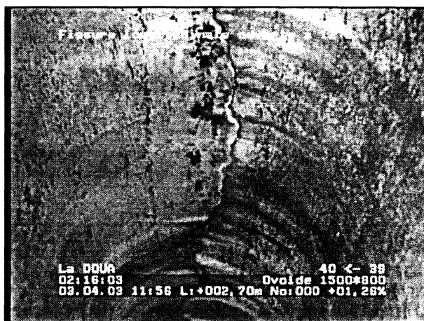
Photo: 23_3a, N° cassette: 1, 02:16:00 2,7m, Fissure longitudinale ouverte à 12 h.
