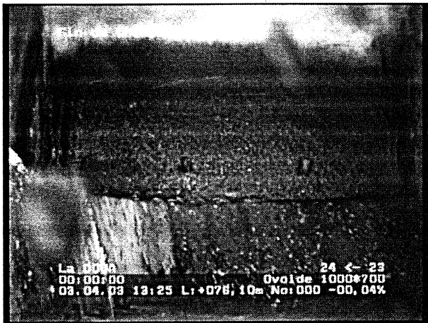
Photo: 25_4a, N° cassette: 1, 02:28:00 76,1m, Fin du tronçon - RV23 (1015)
