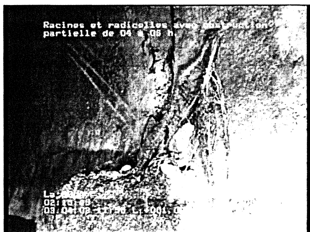
Photo: 23_2a, N° cassette: 1, 02:15:45 1m, Racines et radicelles avec obstruction partielle de 04 à 06 h.
