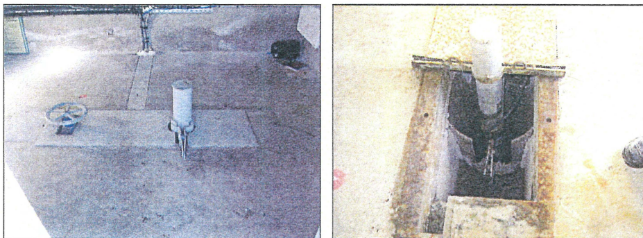
Vue intérieure d'un des locaux techniques
