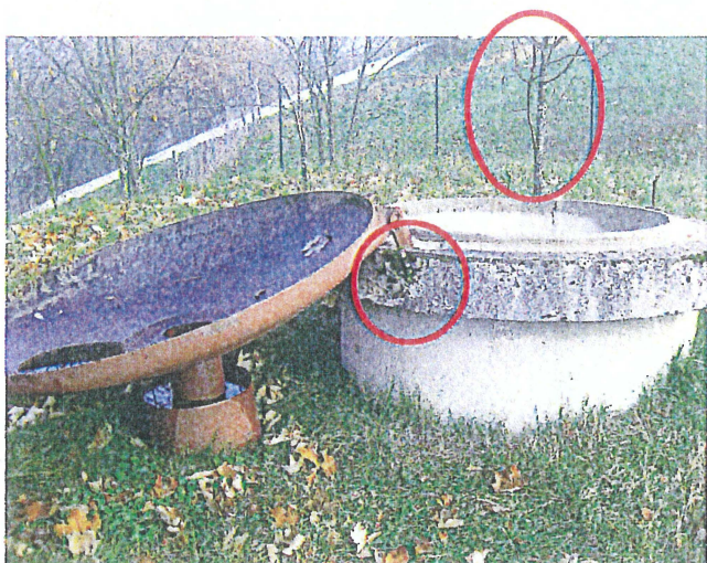
Capot d'accès à la cuve en acier Génie civil de la cheminée à reprendre Arbres sur la cuve à supprimer
