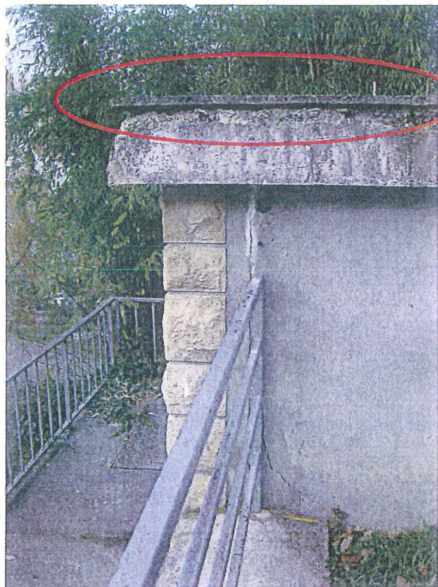
Toit du réservoir en mauvais état + fissures
