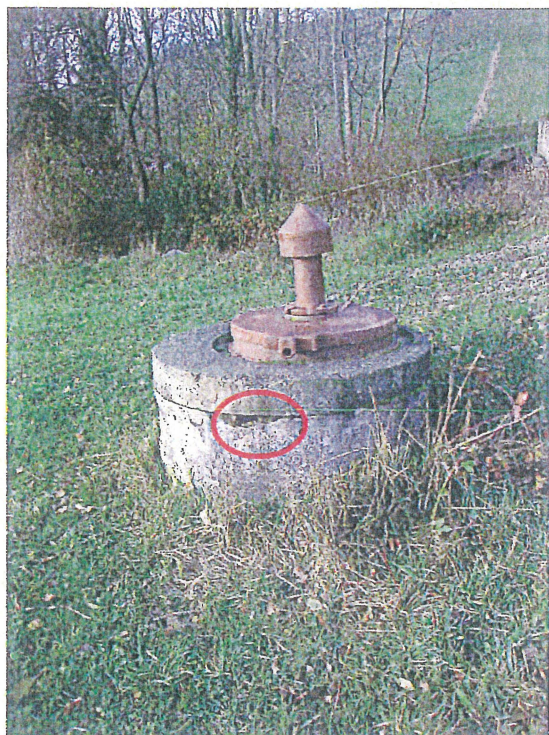
Ouvrage 1 – vue extérieure Trou dans le génie civil
