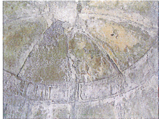
Plafond de l'ouvrage 4 En mauvais état
