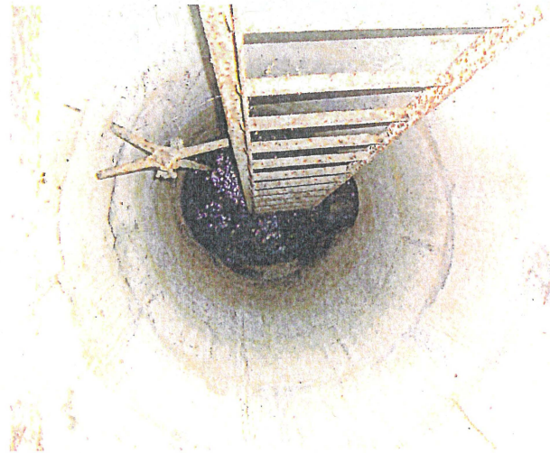
Ouvrage 4 – échelle à changer
