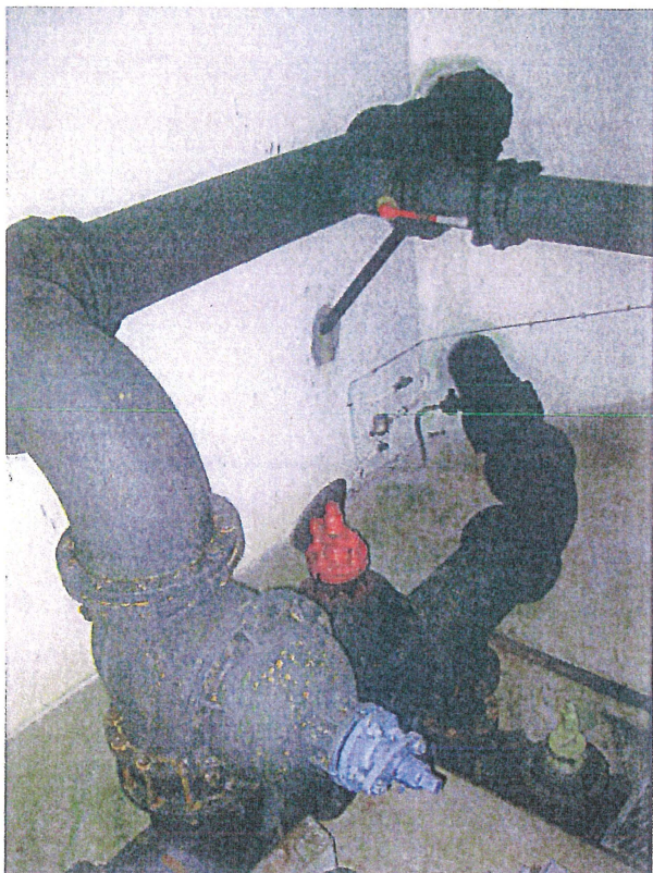
Chambre de vannes
