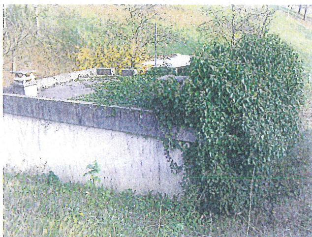
Toit du réservoir envahi par la végétation
