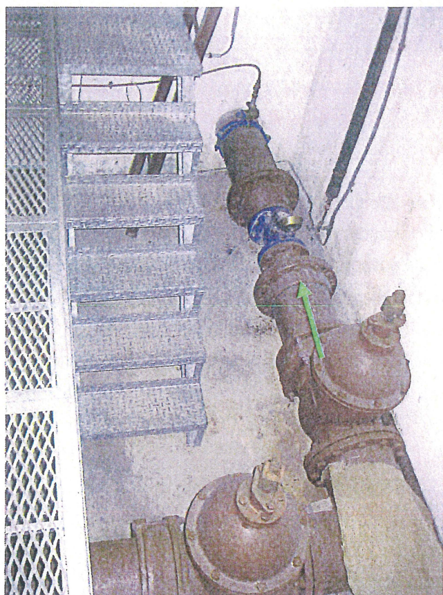
Chambre de vannes Conduite d'adduction de Plan
