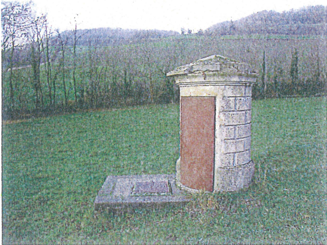
Ouvrage 4 – vue extérieure Génie civil à reprendre
