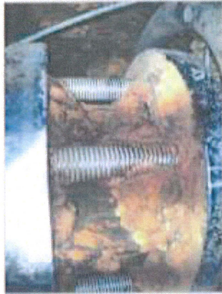
Rouille au niveau du clapet anti-retour
