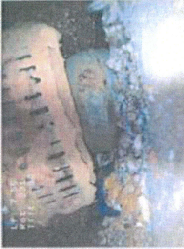
Crépines rouillées de la pompe et support métallique.
