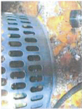
Crépines en inox de la pompe posée sur le fond. Rouille sur les crépines du haut. Dépôt de sable et de particules de rouille. Vis tombée au fond du puits.
