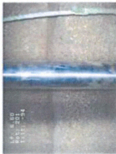
Conduite de refoulement en inox et contact entre 2 buses béton.
