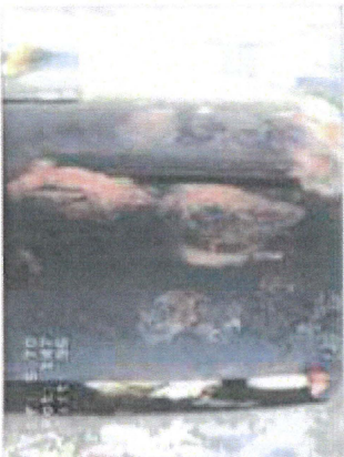
Vue en gros plan des crépines (trous oblongs). Gravier visible derrière les crépines. Cloques de rouille sur le tubage.
