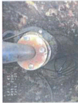
Vue d'ensemble du fond du puits P2 avec pompe, cloques de rouille sur le tubage, crépiné et dépôt sableux au fond.
