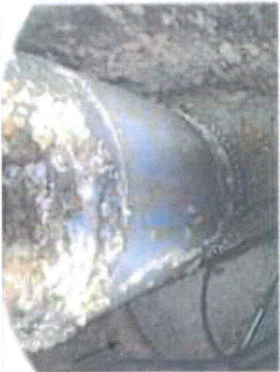
Vue de la pompe d'exploitation du P2. Parties hautes et basses rouillées. A noter les concrétions au bas du tubage (flèche)
