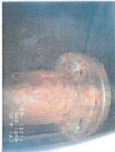
Coude en acier rouillé - suite de la conduite de refoulement.
