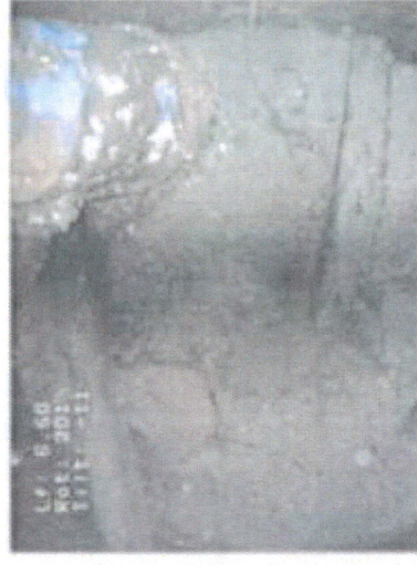
Fond du puits avec alluvions (permettant la remontée d'eau par le fond) et dépôts divers (morceaux de bois et galets).
