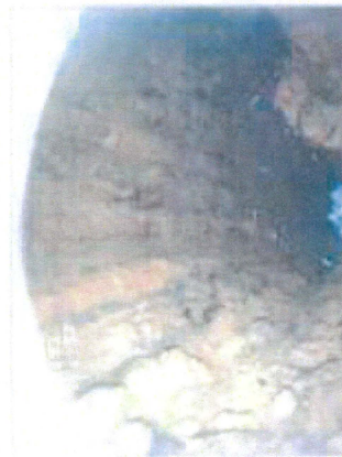
Importantes concrétions de rouille sur le tubage du puits et le tuyau de renforcement en acier dans la zone de battement de la nappe.
