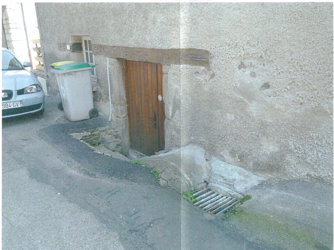
F8 - Inondations fréquentes par ruissellement (TART-D2)
