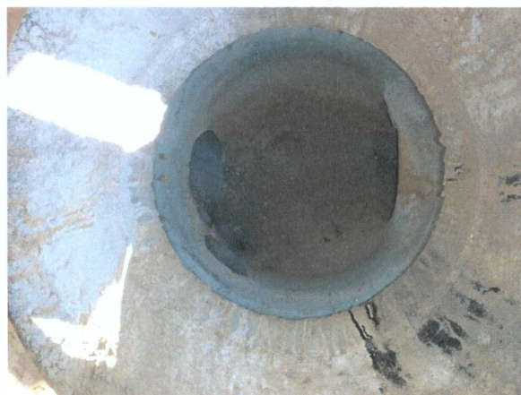
Regard EP n°2029 – Virole fissurée
