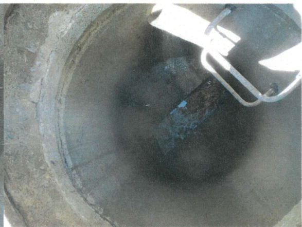
Regard U n°2067 – Dépôts et stagnation d'effluents
