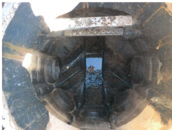
Regard U n°2022 – Stagnation d'effluents
