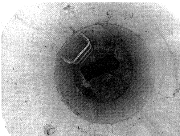
Regard EP n°2071 – Radier dégradé
