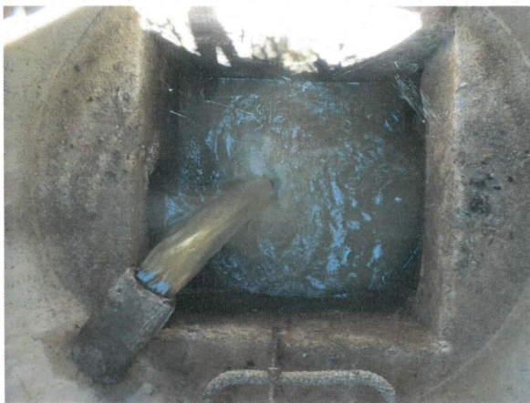
Regard U n°2065 – Absence de cunette
