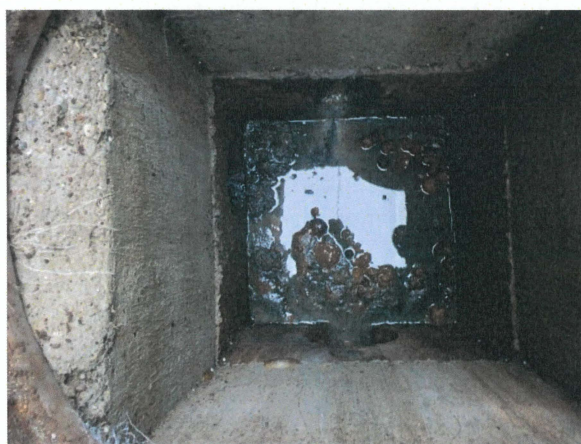
Regard U n°2082 – Absence de cunette
