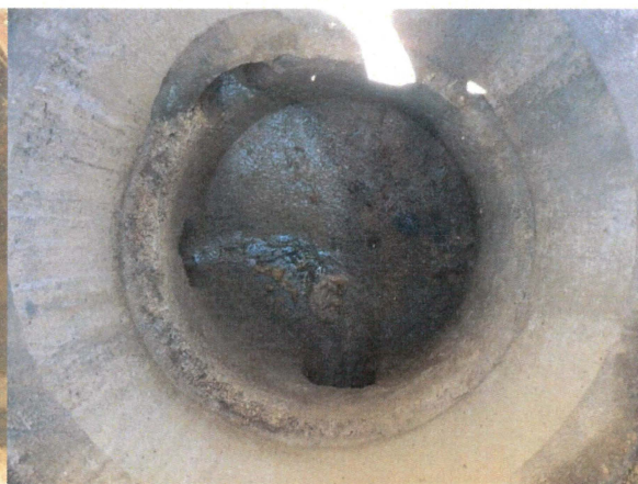
Regard U n°2036 – Absence de cunette
