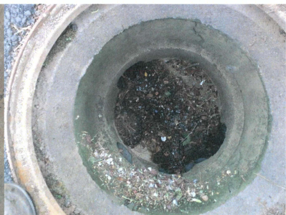
Regard EP n°2085 – Virole fissurée
