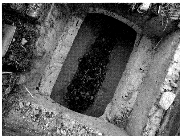
Regard EP n°2102 – Jonction cunette/banquette non étanche
