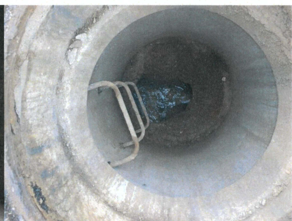
Regard U n°2086 – Radier dégradé
